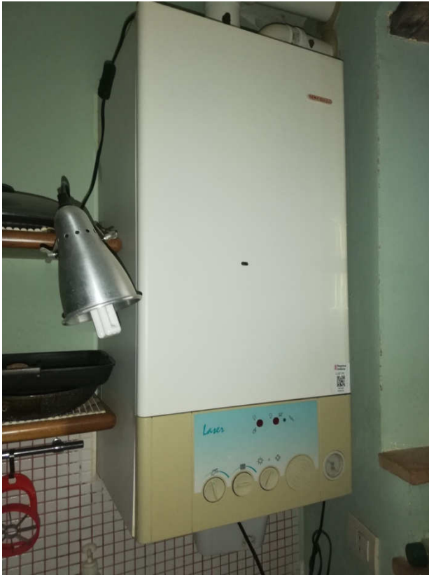
13) Particolari: caldaia in locale cucina
