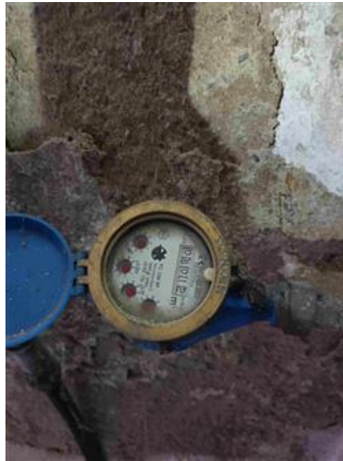
contatore acqua comune interno alla cantina
