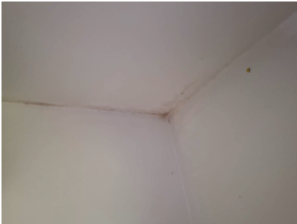
FOTO 8 – Particolare d'angolo con formazione di muffe.
