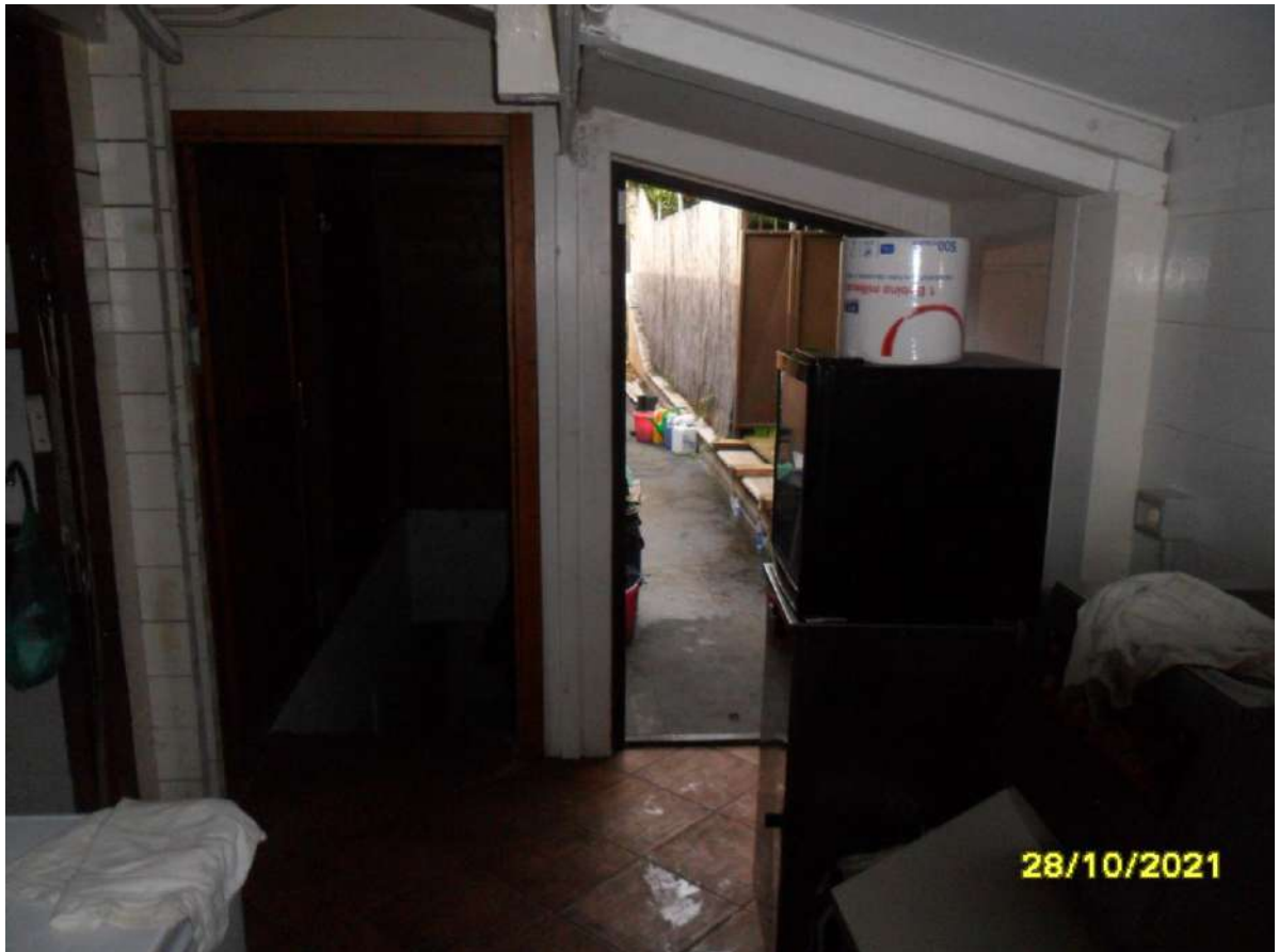
piano primo: ampliamento dispensa retro-cucina (realizzato in difformità rispetto a quanto assentito con il titolo edilizio)
