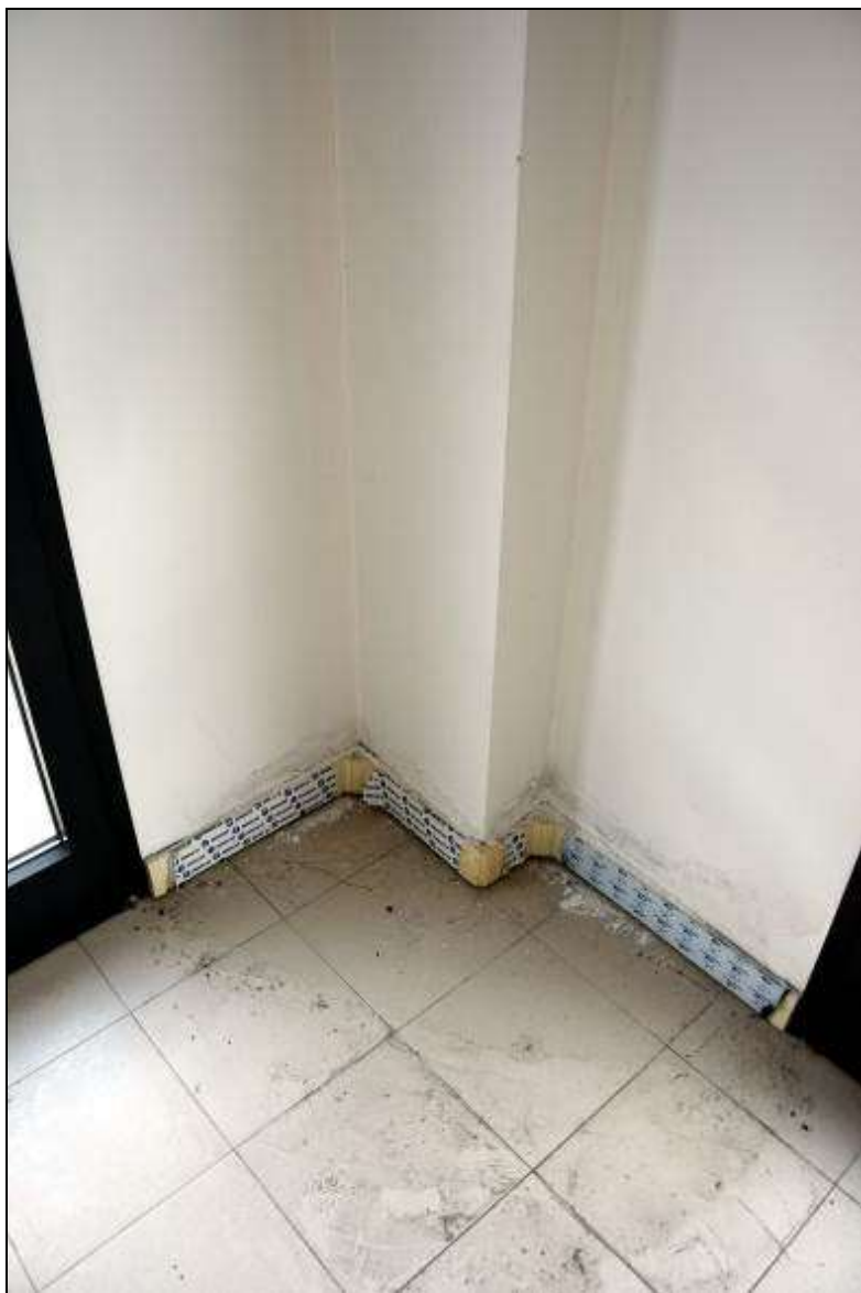
FOTO 11 – infiltrazioni di umidità
