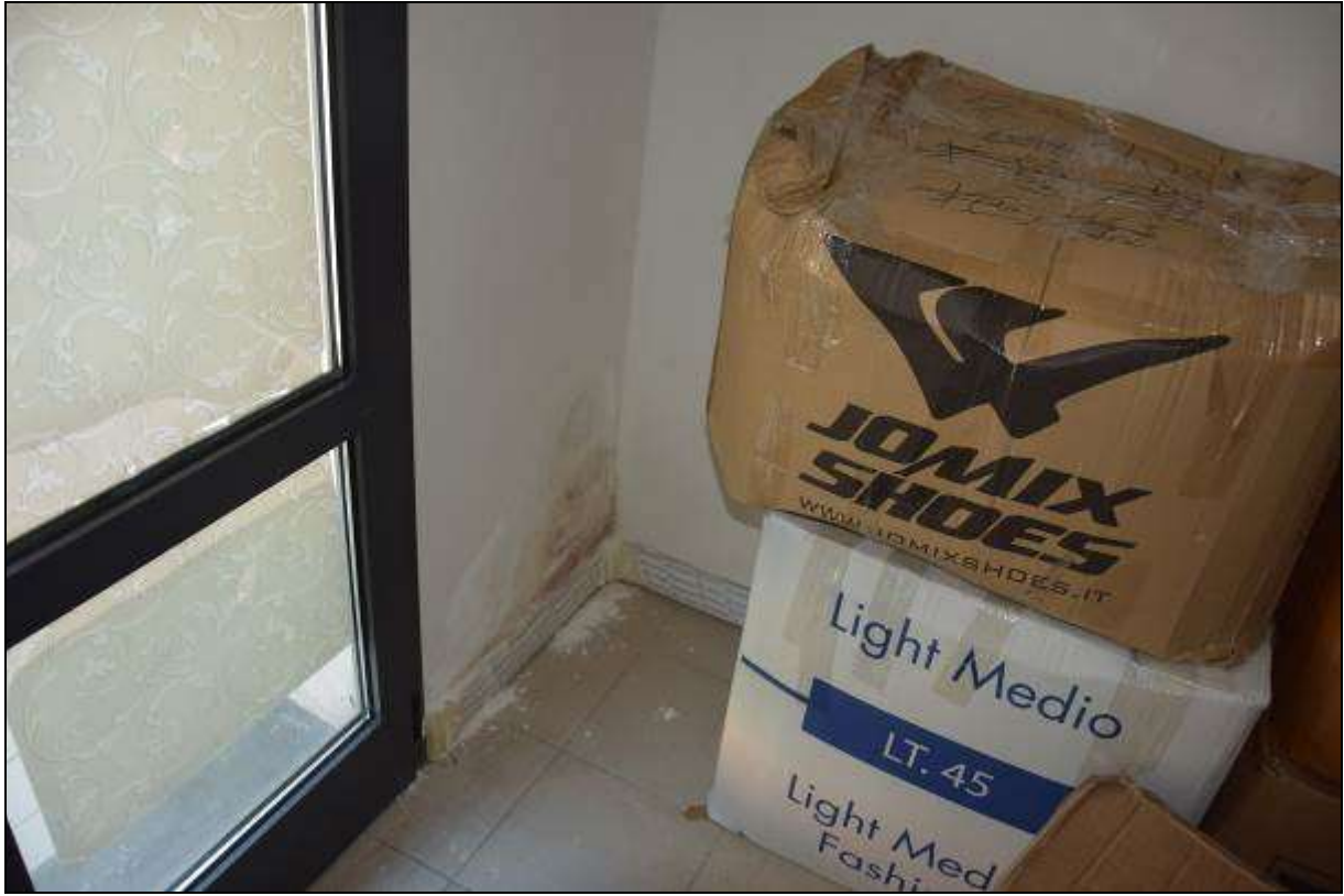
FOTO 13 – infiltrazione di umidità proveniente dalla terrazza
