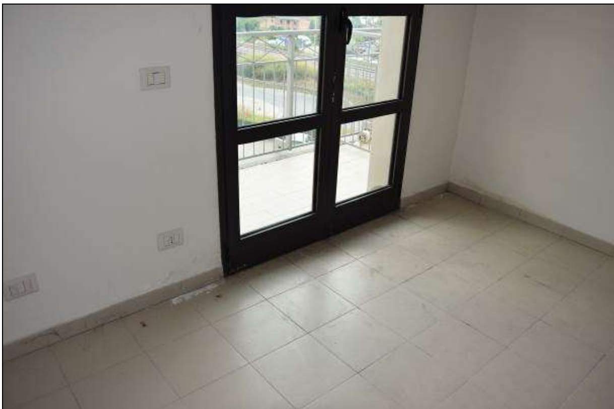
FOTO 25 – infiltrazioni di umidità
