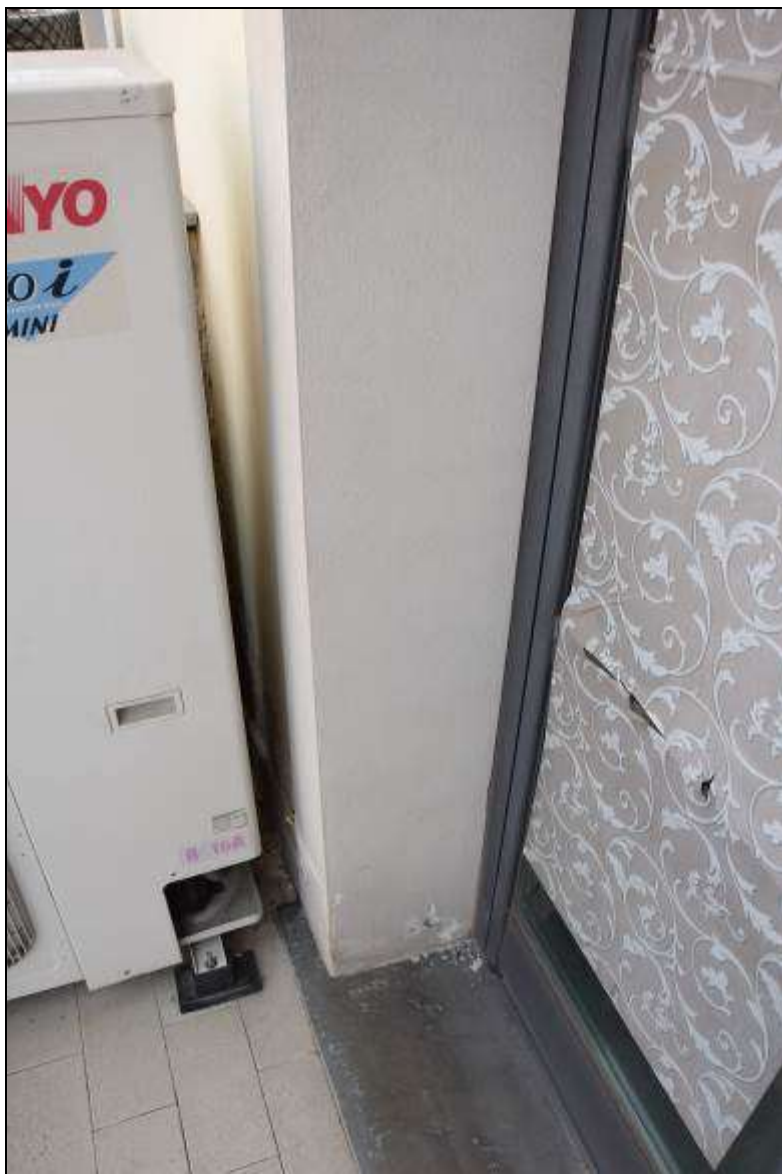
FOTO 11 – infiltrazione di umidità
