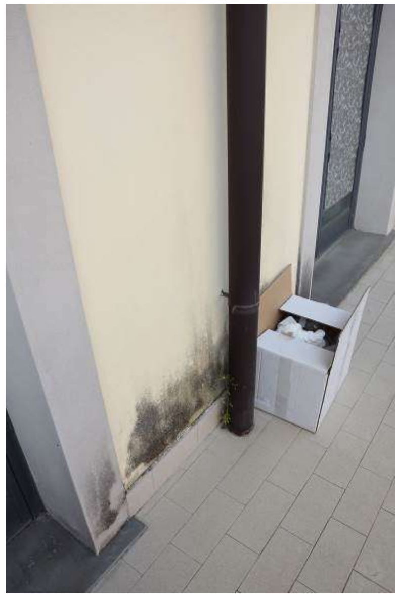
FOTO 12 – infiltrazione di umidità
