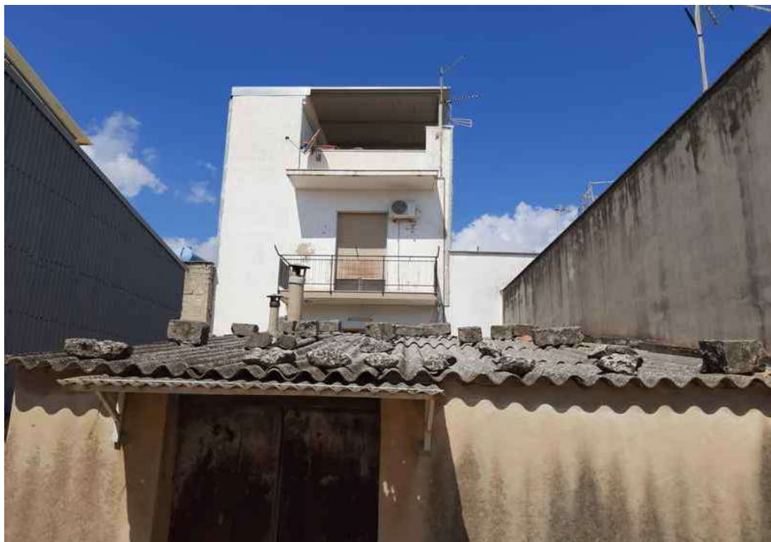
G.34 – Veduta del Terrazzo lato Ovest – particolare del tetto in eternit.
