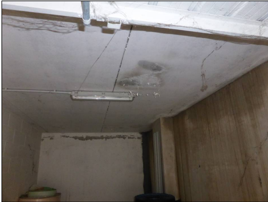
Foto n. 7 – Dettaglio delle infiltrazioni d'acqua sul solaio e sulle murature perimetrali
