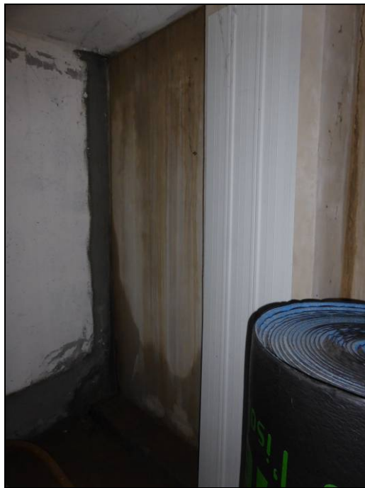
Foto n. 8 – Dettaglio delle infiltrazioni d'acqua sulle murature perimetrali
