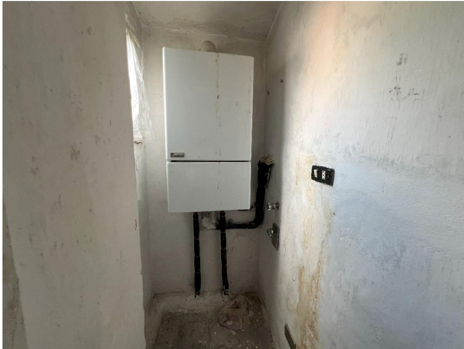
Foto 11. Caldaia non funzionante
