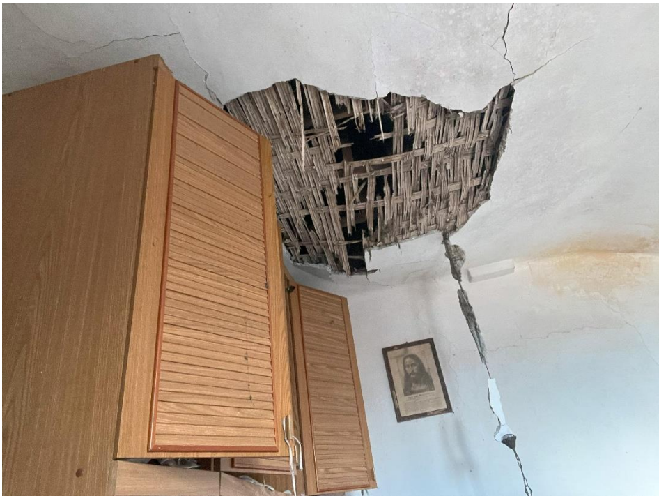
Foto 14. Particolare controsoffitto pericolante in fase di distacco
