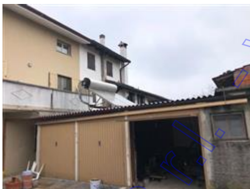
Pannelli solari sulla copertura dell'autorimessa
