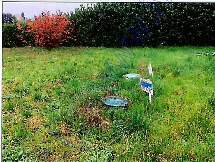
5. Fotografia area esterna mappale 319 con serbatoi GPL
