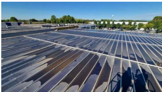
Foto 5: evidenza di sporcizia e ristagno d'acqua sui moduli fotovoltaici
