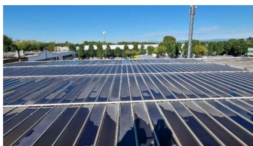
Foto 2: vista dei pannelli di silicio amorfo su tetto
