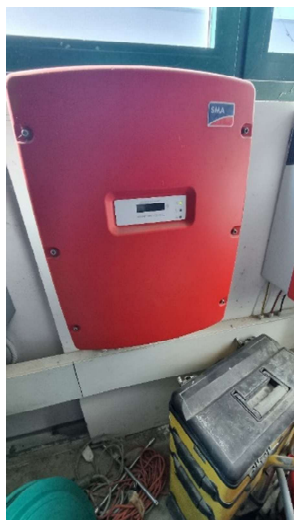
Foto 3: particolare inverter SMA
