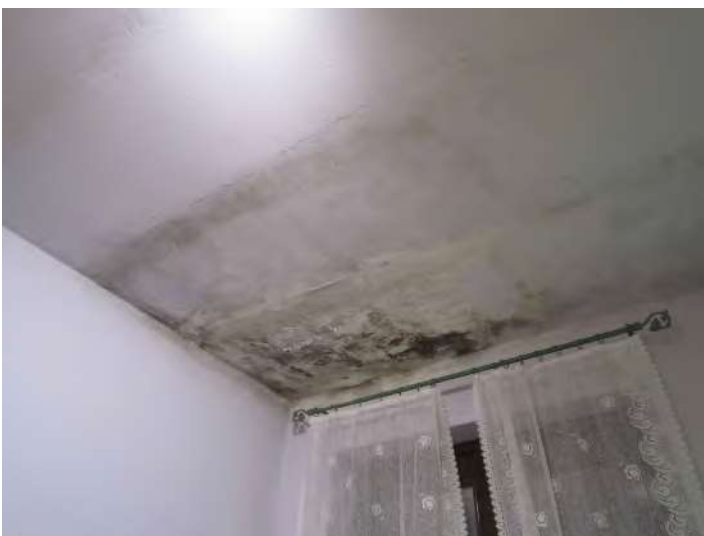
VISTA MACCHIE DI UMIDITA' SUL SOFFITTO DELLA LAVANDERIA
