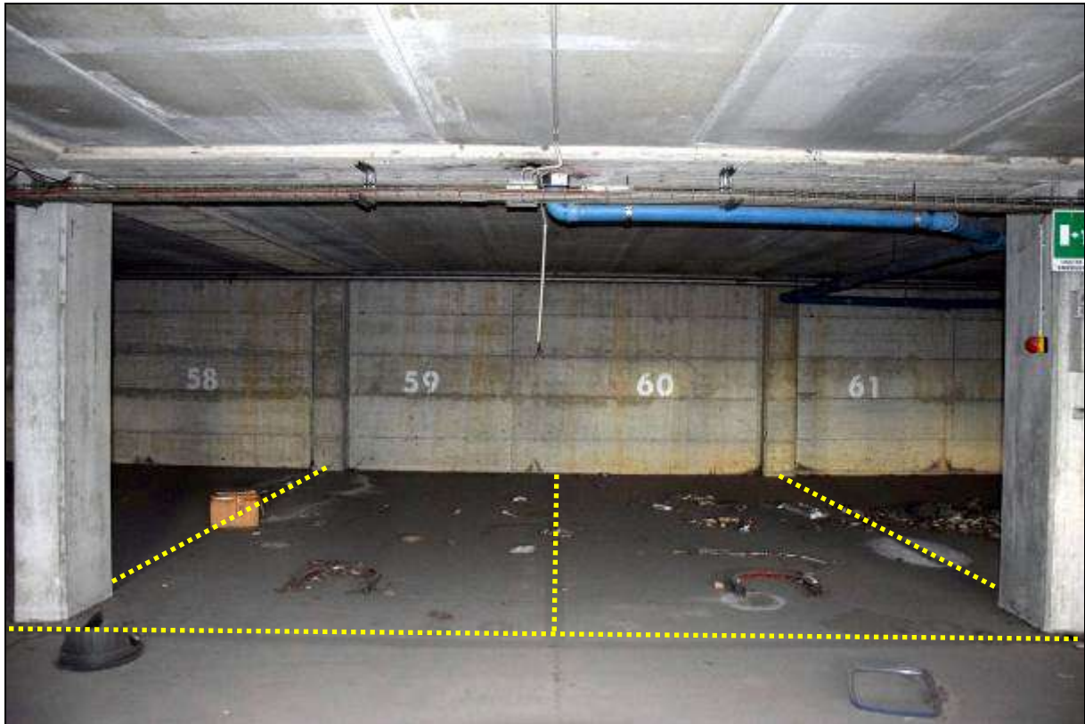
FOTO 1 – SUB 63 (POSTO 59) / SUB 64 (POSTO 60)
