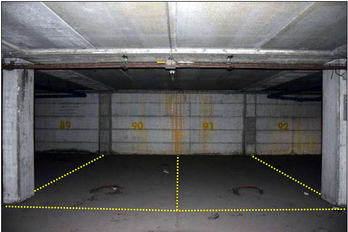
FOTO 6 – SUB 77 (POSTO 90) / SUB 78 (POSTO 91)
