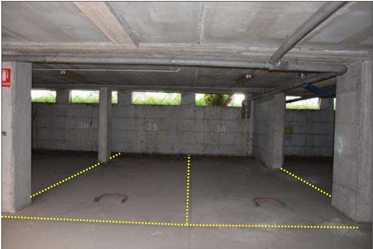
FOTO 3 – SUB 115 (POSTO 35) – SUB 116 (POSTO 34)
