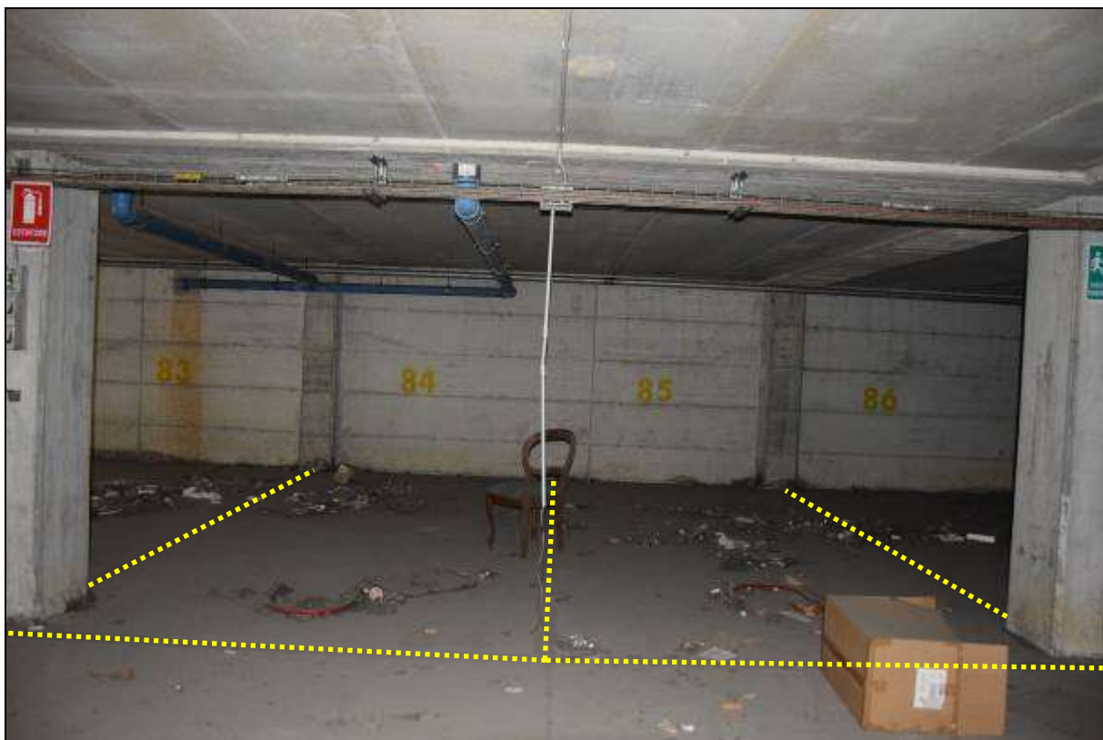
FOTO 3 – SUB 71 (POSTO 84) / SUB 72 (POSTO 85)
