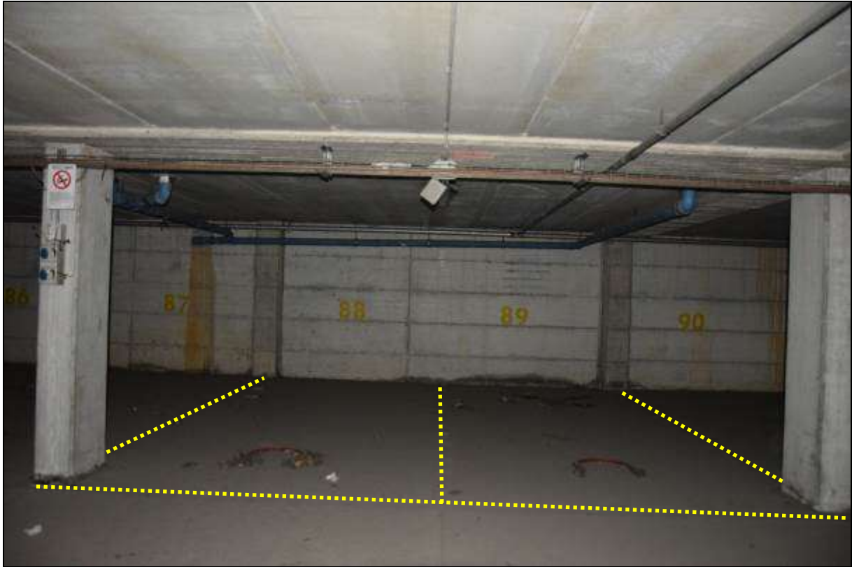
FOTO 5 – SUB 75 (POSTO 88) / SUB 76 (POSTO 89)
