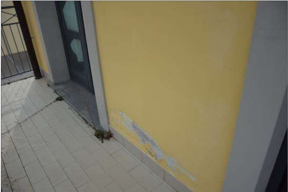
FOTO 9 - umidità causa infiltrazioni dalla terrazza
