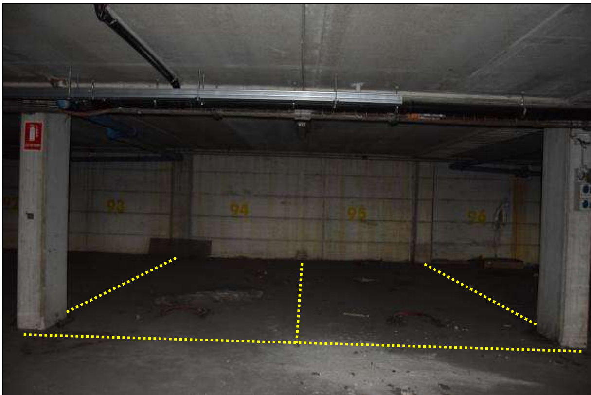
FOTO 8 – SUB 81 (POSTO 94) / SUB 82 (POSTO 95)
