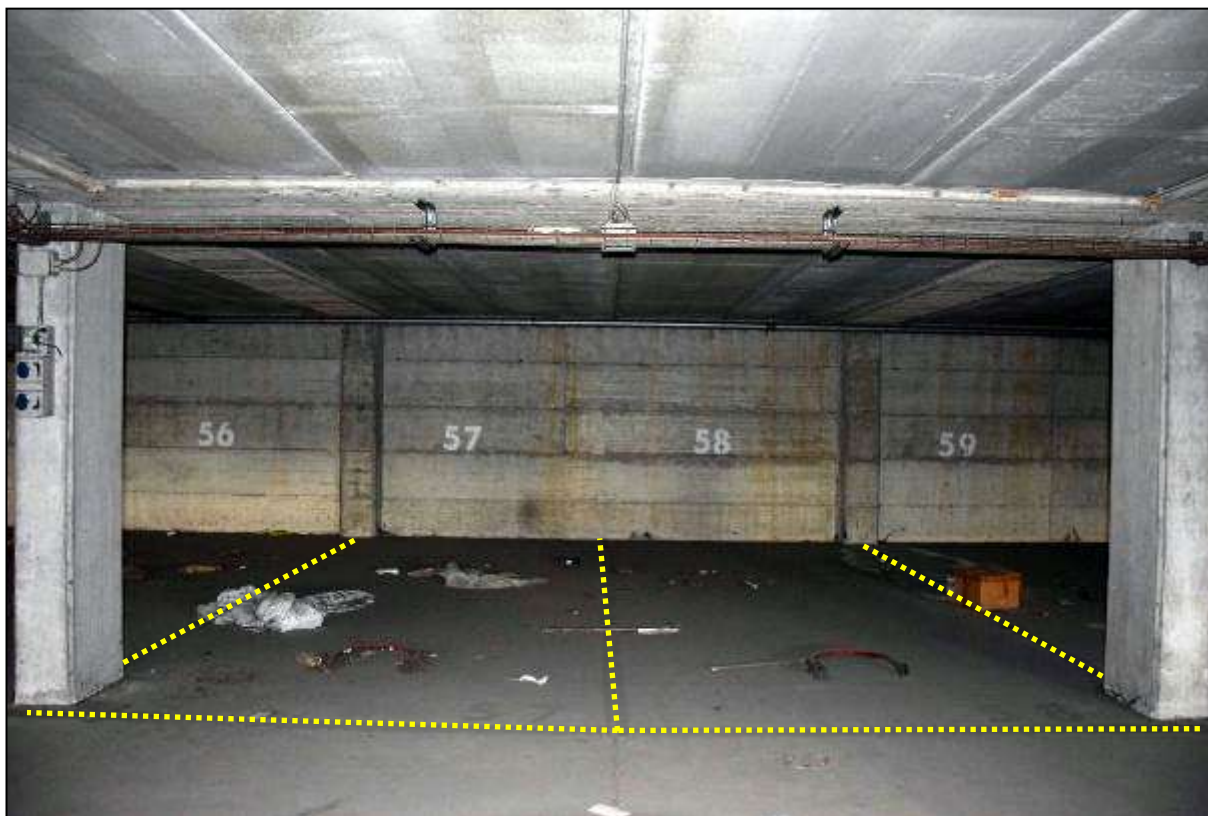
FOTO 1 – SUB 61 (POSTO 57) / SUB 62 (POSTO 58)
