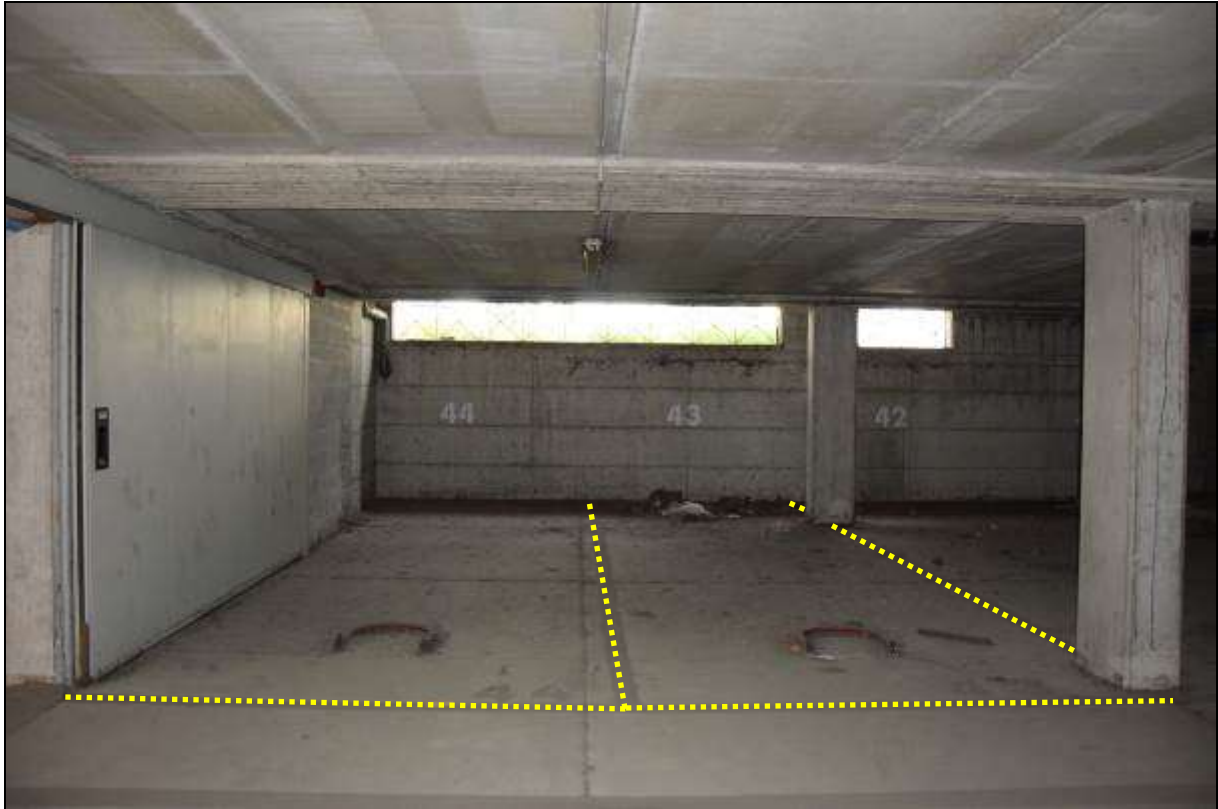
FOTO 1 – SUB 106 (POSTO 44) / SUB 107 (POSTO 43)
