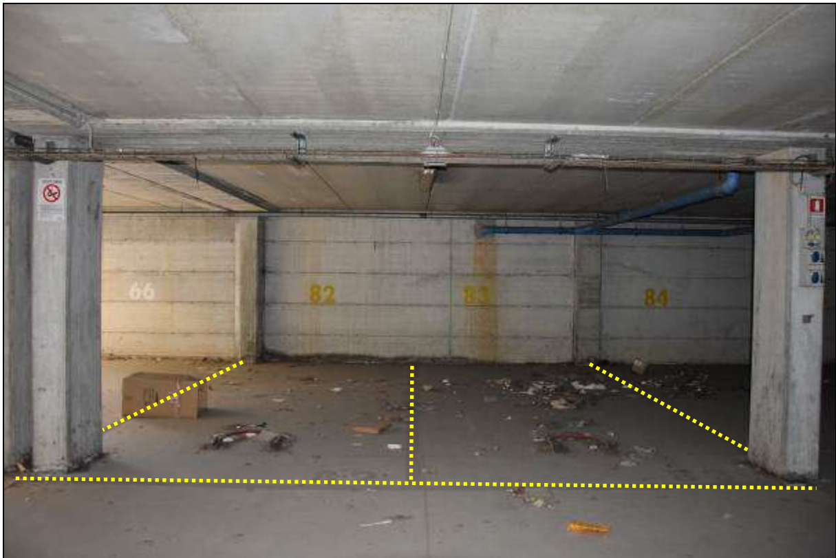
FOTO 2 – SUB 69 (POSTO 82) / SUB 70 (POSTO 83)
