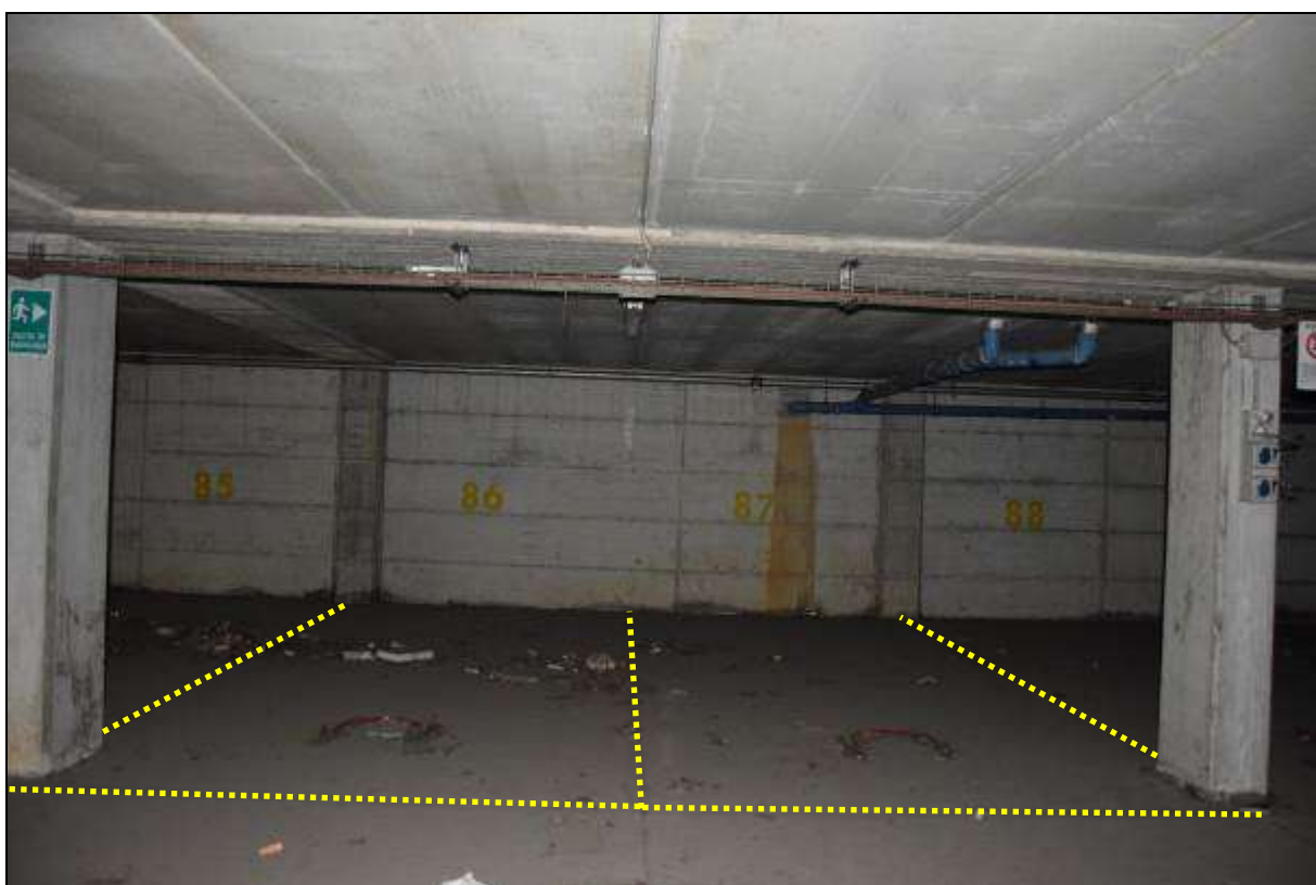
FOTO 4 – SUB 73 (POSTO 86) / SUB 74 (POSTO 87)
