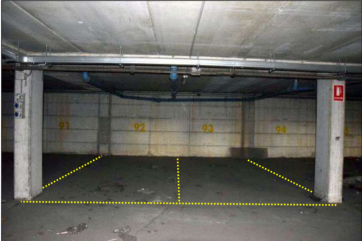
FOTO 7 – SUB 79 (POSTO 92) / SUB 80 (POSTO 93)
