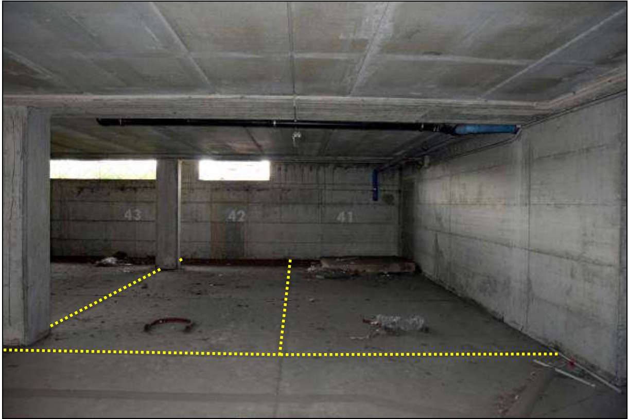
FOTO 1 – SUB 108 (POSTO 42) / SUB 109 (POSTO 41)
