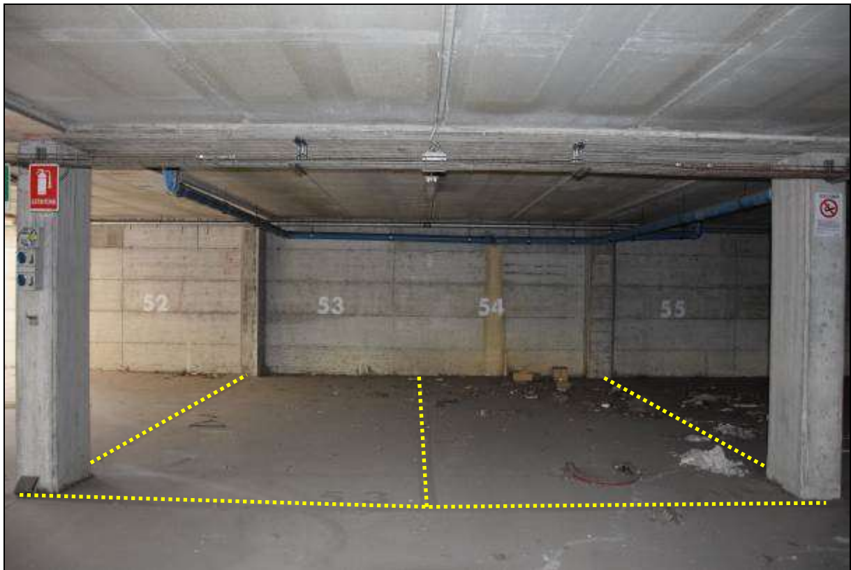
FOTO 1 – SUB 57 (POSTO 53) / SUB 58 (POSTO 54)
