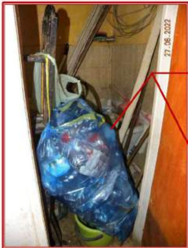
Piano Terra Ripostiglio con accesso adiacente alla parete attrezzata a cucina (A)
