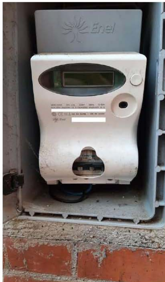
Foto n. 46 – Contatore energia elettrica
