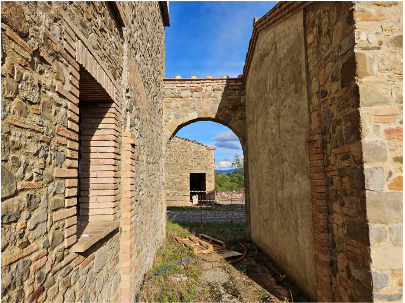
Vista portale di accesso al complesso immobiliare da via del Cipressino alla corte interna
