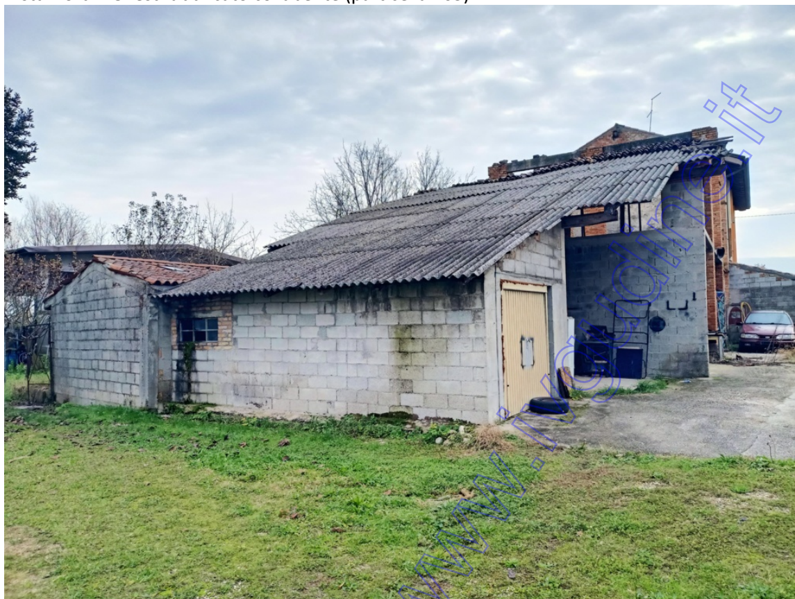
Vista Nord – Ovest fabbricato collabente (particella 163)
