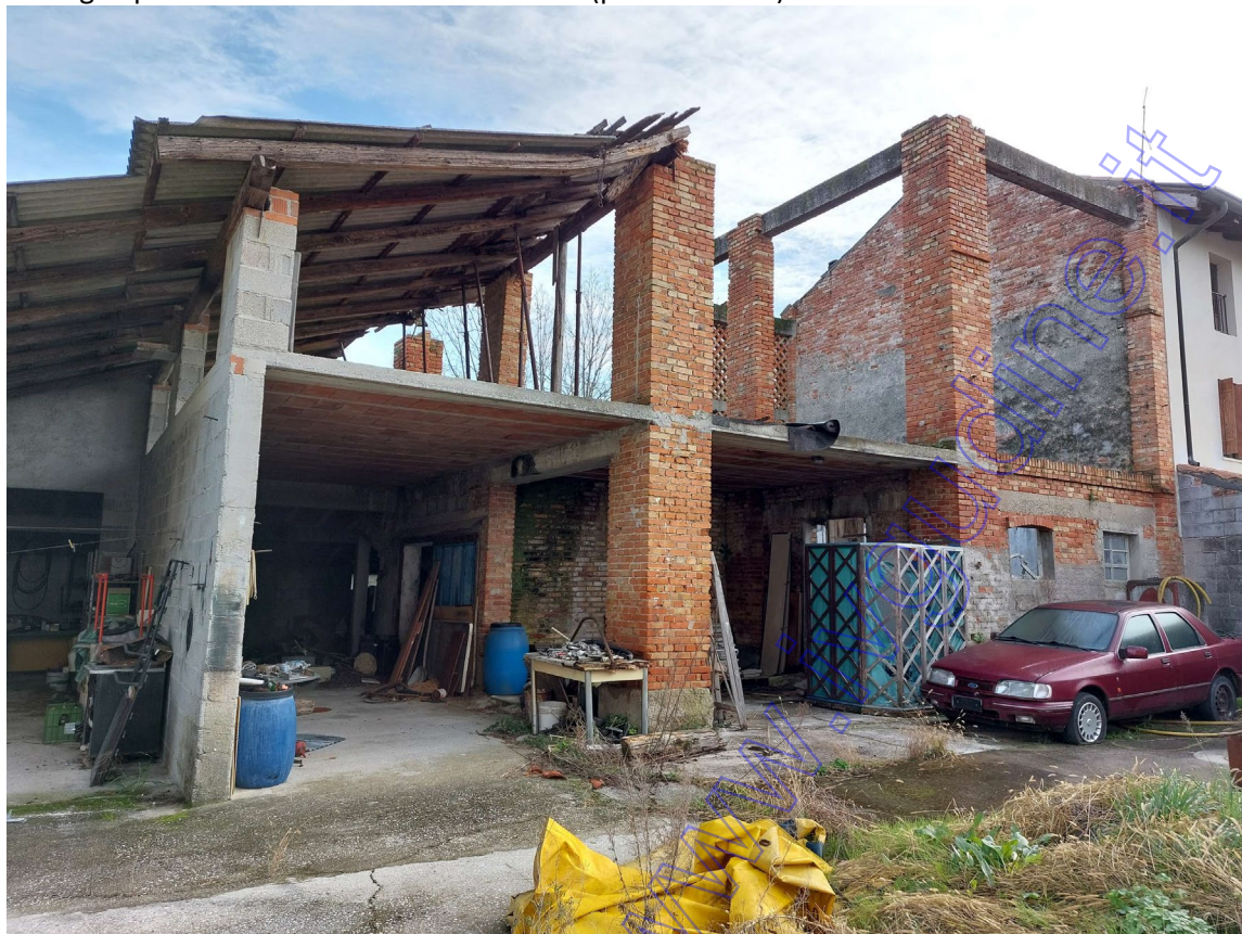
Dettaglio parete Ovest fabbricato collabente (particella 163)
