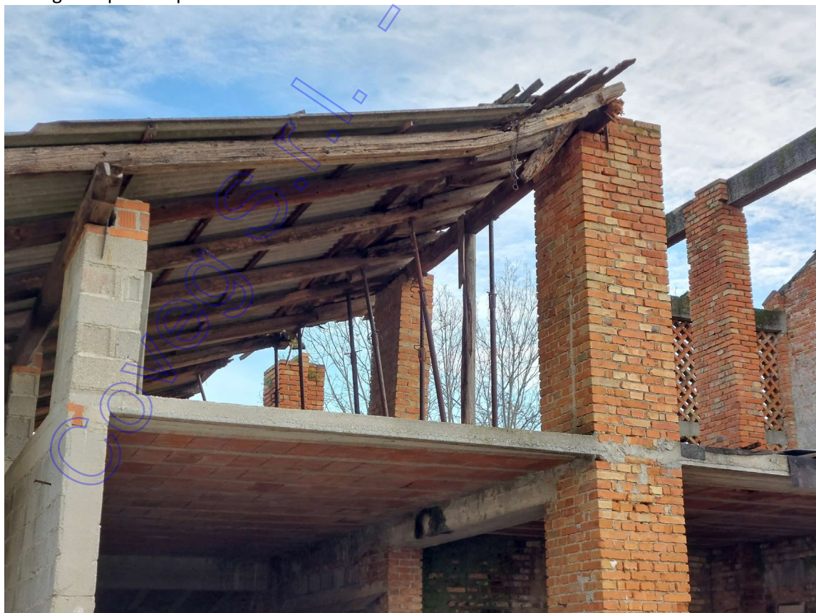
Dettaglio copertura pericolante
