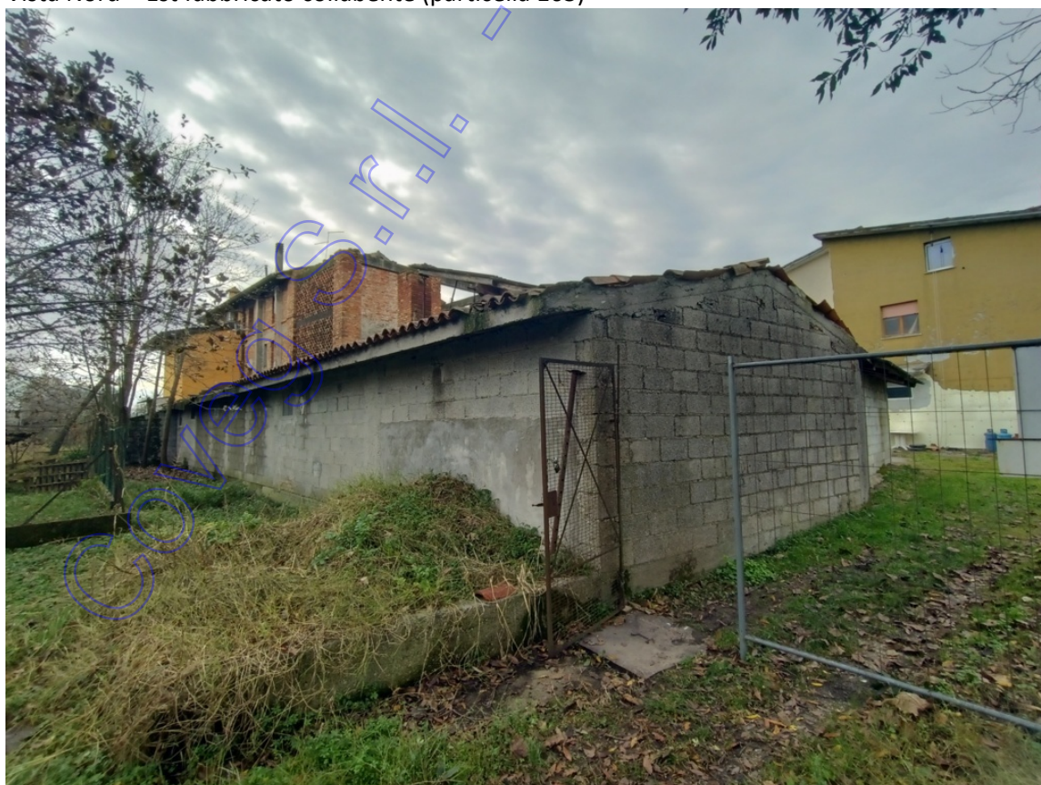
Vista Nord – Est fabbricato collabente (particella 163)
