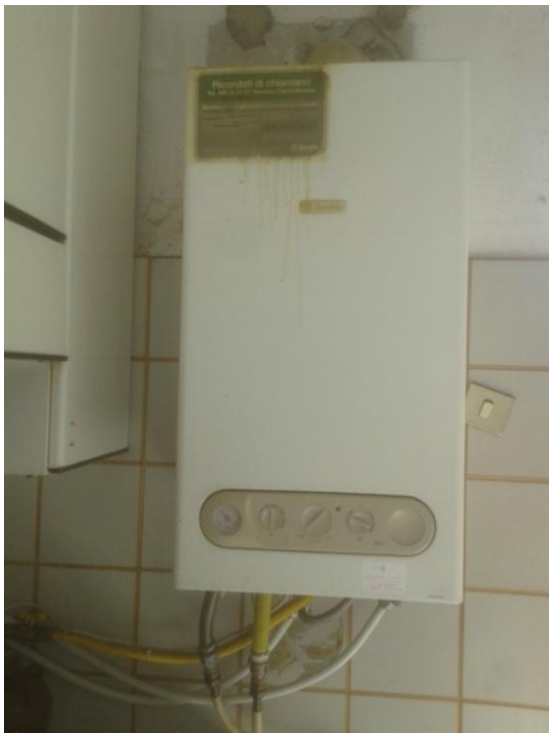
Foto 13 Boiler posto in cucina
