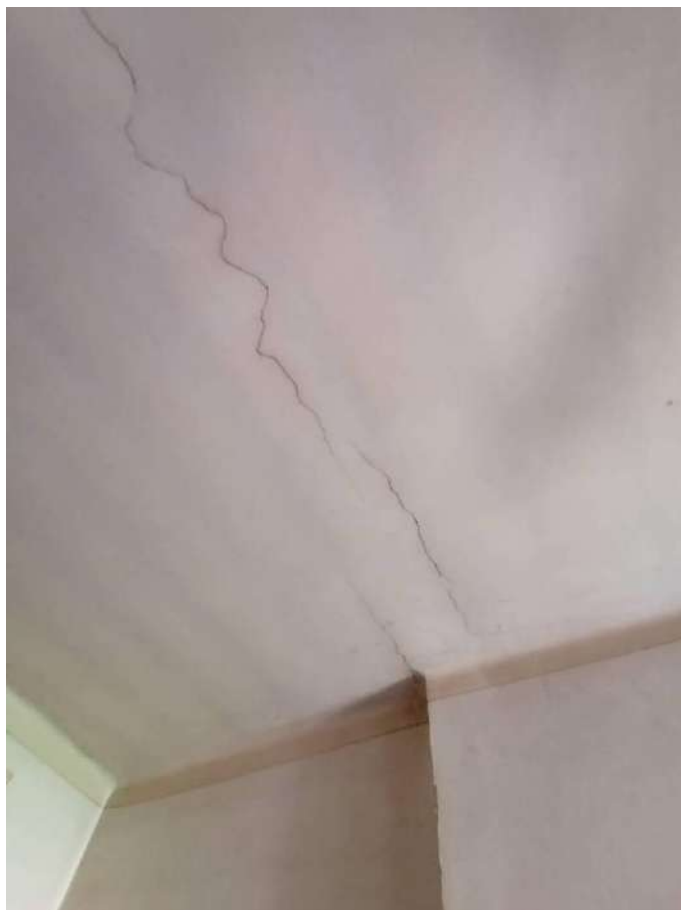
FOTO 23 (particolare delle lesioni all'intradosso del solaio del sottotetto in cucina)
