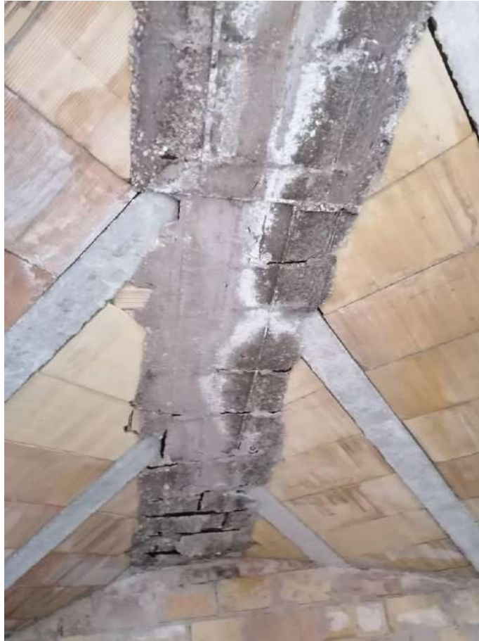
FOTO 140 (particolare del degrado locale rilevato su una trave di copertura – piano 3°)
