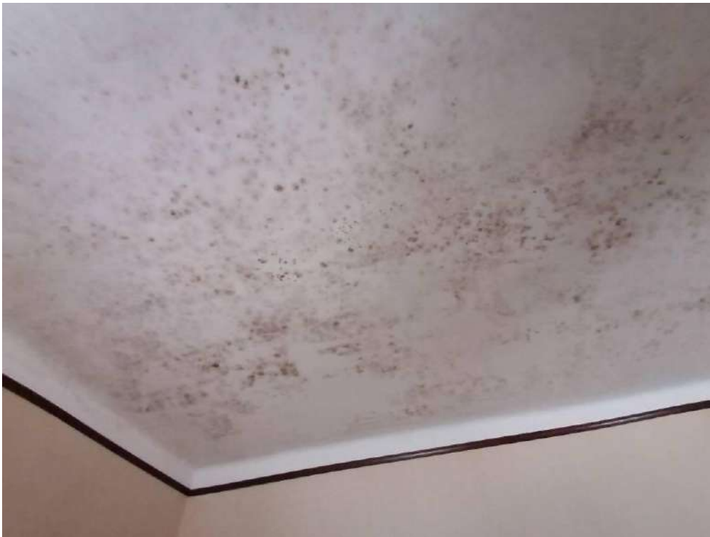
FOTO 59 (particolare dell'umidità all'intradosso del solaio del sottotetto in camera da letto)
