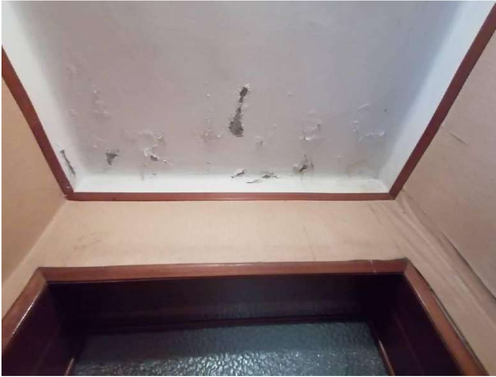
FOTO 46 (particolare dell'intradosso del solaio piano sottotetto, presenza di umidità)
