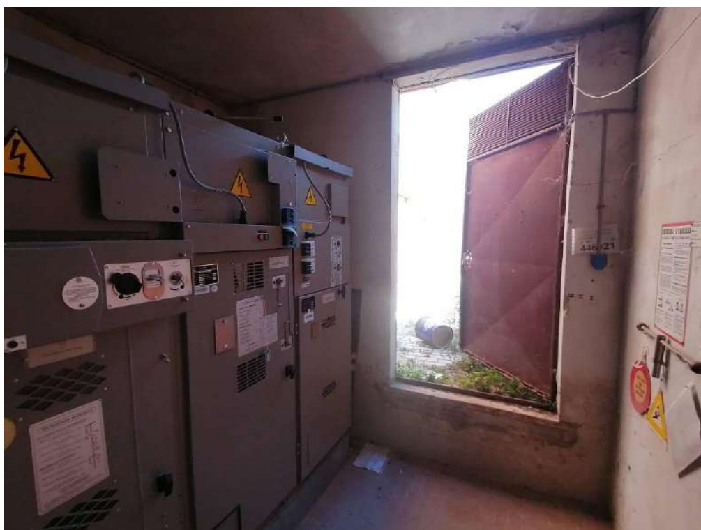
FOTO 143 (centrale enel esterna– piano T)
