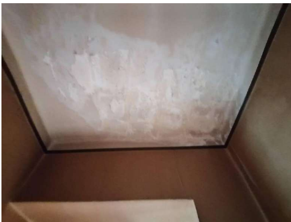
FOTO 30 (particolare delle infiltrazioni all'intradosso del solaio del sottotetto nel disimpegno)
