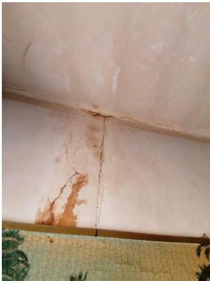
FOTO 22 (particolare delle infiltrazioni in cucina)
