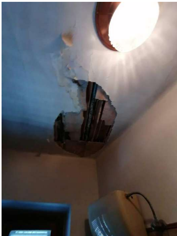
FOTO 52 (locale sfondellamento all'intradosso del solaio del sottotetto nel bagno)
