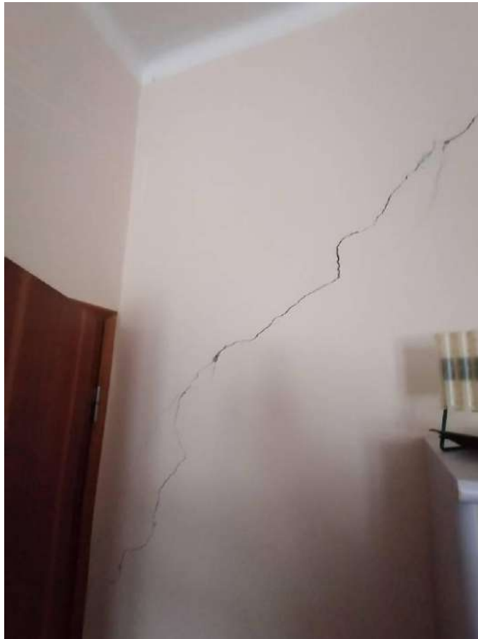
FOTO 7 (particolare di una lesione presente nella camera da letto)
