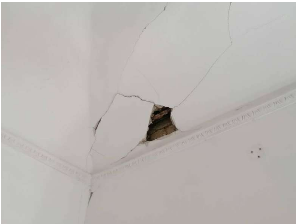
FOTO 151 (presenza di lesioni sul soffitto del locale sud-ovest)
