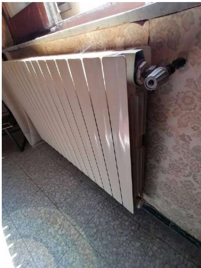
FOTO 25 (particolare dell'impianto di riscaldamento)
