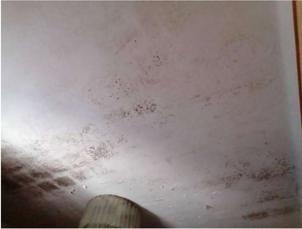
FOTO 62 (particolare dell'umidità all'intradosso del solaio del sottotetto in soggiorno)
