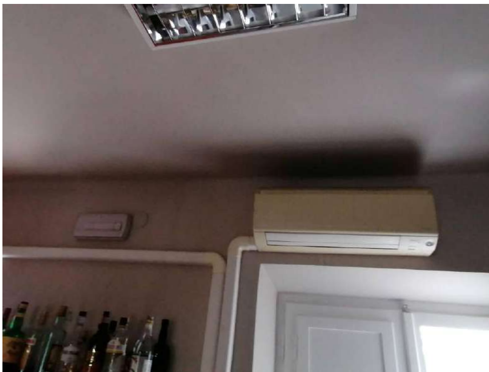
FOTO 75 (particolare impianto di condizionamento e riscaldamento)
