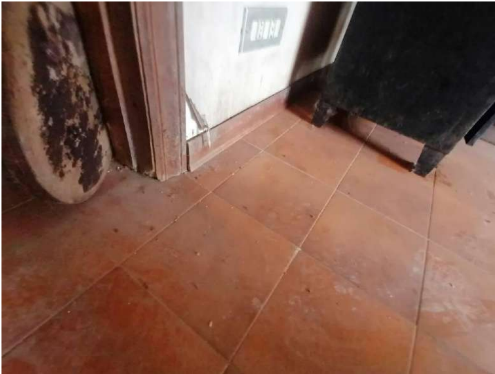
FOTO 115 (particolare pavimento locali sala di attesa, disimpegno, ufficio – piano 1°)
