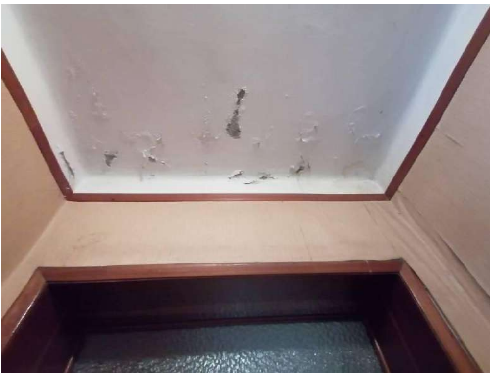
FOTO 18 (particolare dell'intradosso del solaio piano sottotetto, presenza di umidità)
