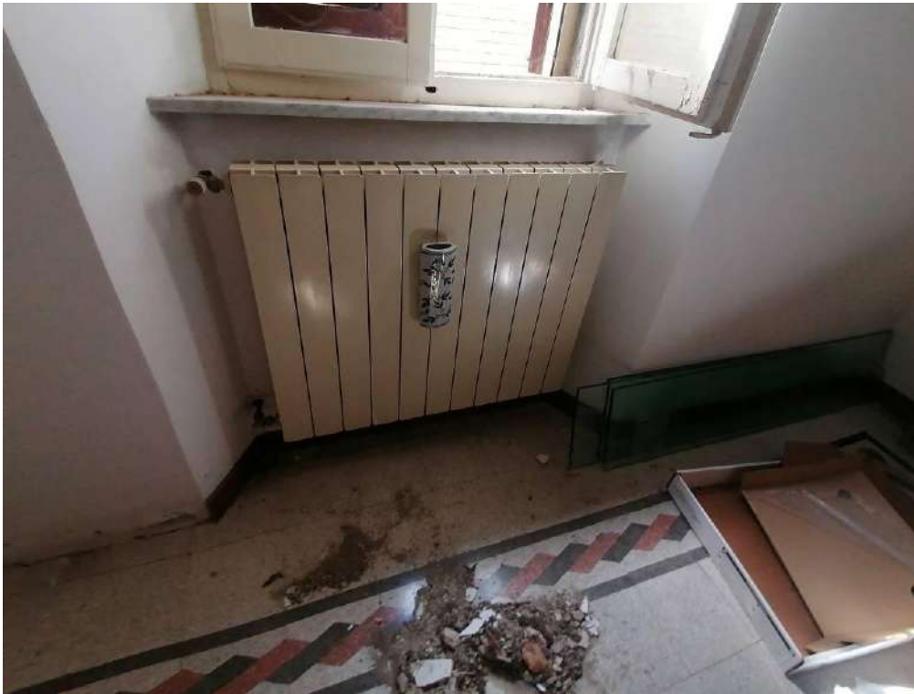
FOTO 152 (particolare impianto di riscaldamento)
