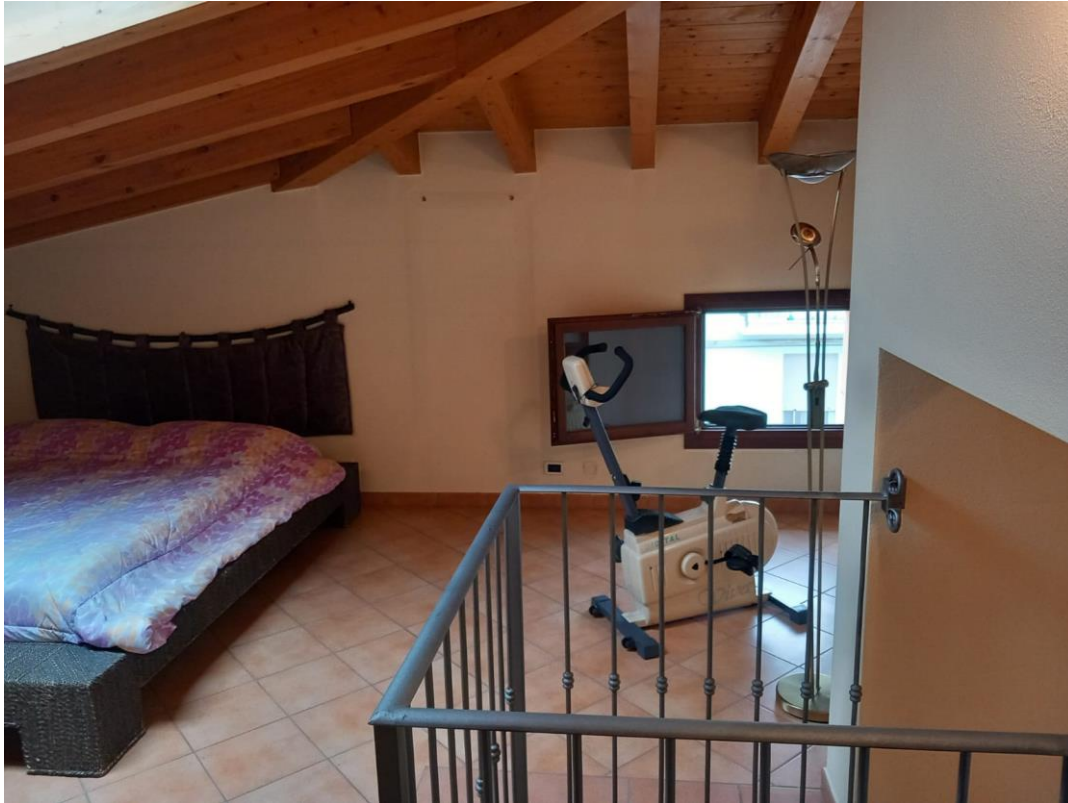
SOFFITTA (UTILIZZATA IMPROPRIAMENTE COME CAMERA DA LETTO)
