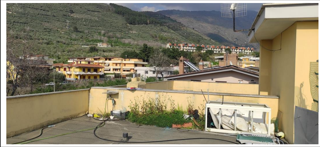
FOTO N. 24 VEDUTA DEL LATRICO SOLARE
