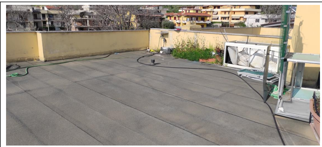
FOTO N. 26 VEDUTA DEL LATRICO SOLARE
