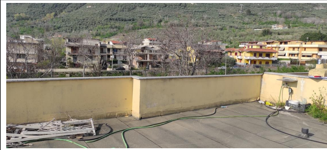
FOTO N. 25 VEDUTA DEL LATRICO SOLARE
