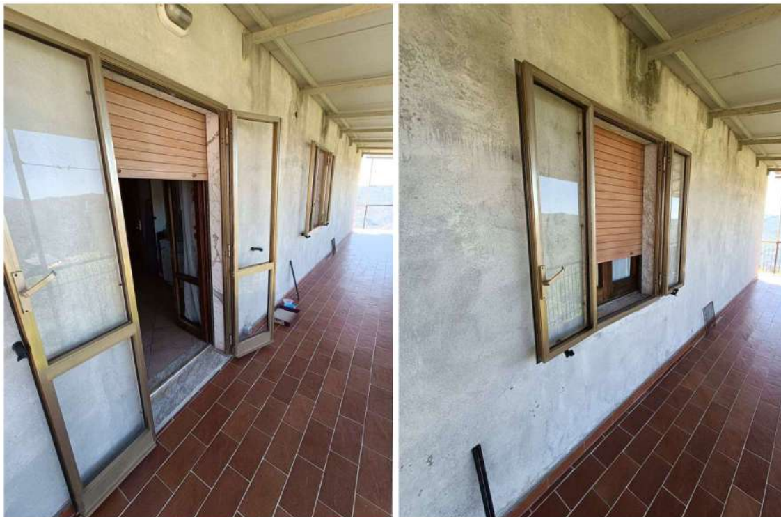
Figura 20: Vista degli unici infissi esterni presenti nell'immobile 1 (lato ovest)
