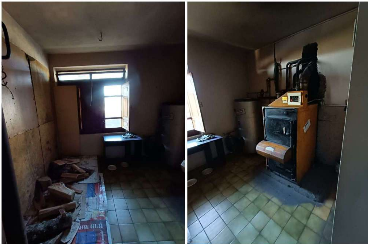
Figura 23: Vista interna locale caldaia
