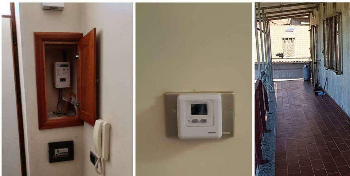
Figura 21: Vista di Impianto elettrico e citofono (a sinistra) termostato (al centro) bombola del gas (a destra)
