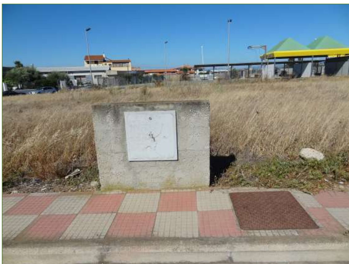
Foto n° 5: Predisposizioni impiantistiche lungo la via Tevere
