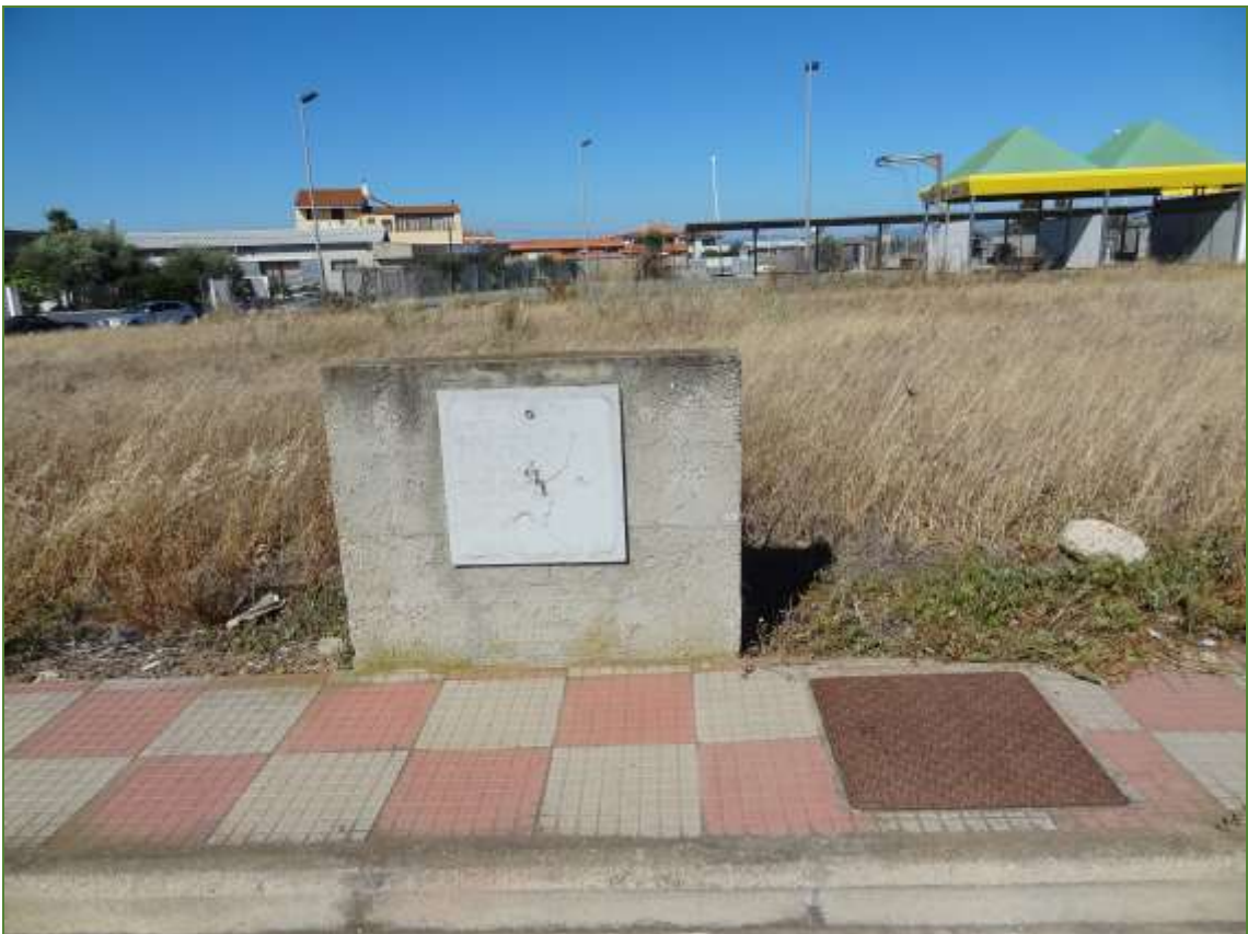
Foto n° 5: Predisposizioni impiantistiche lungo la via Tevere
