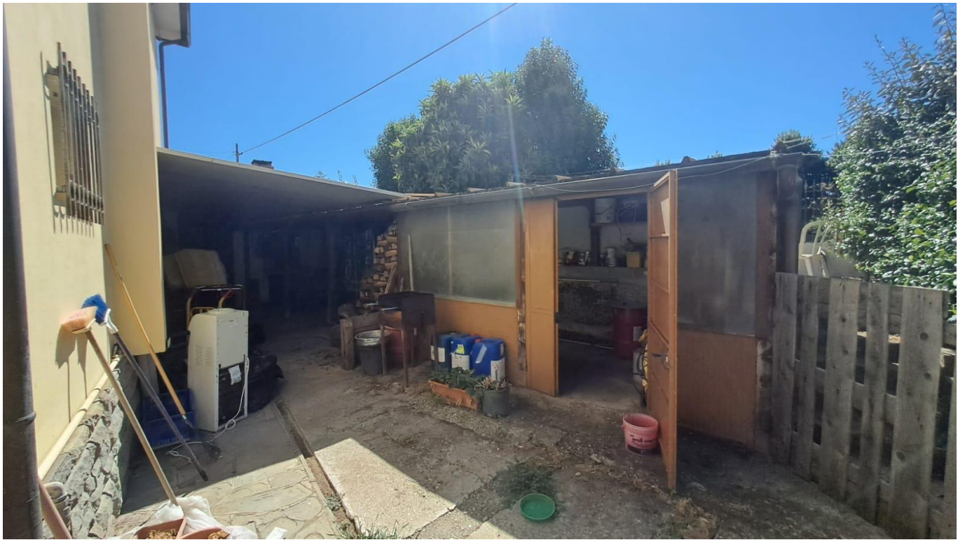
Foto 7 – Manufatti privi di autorizzazione (retro fabbricato)
