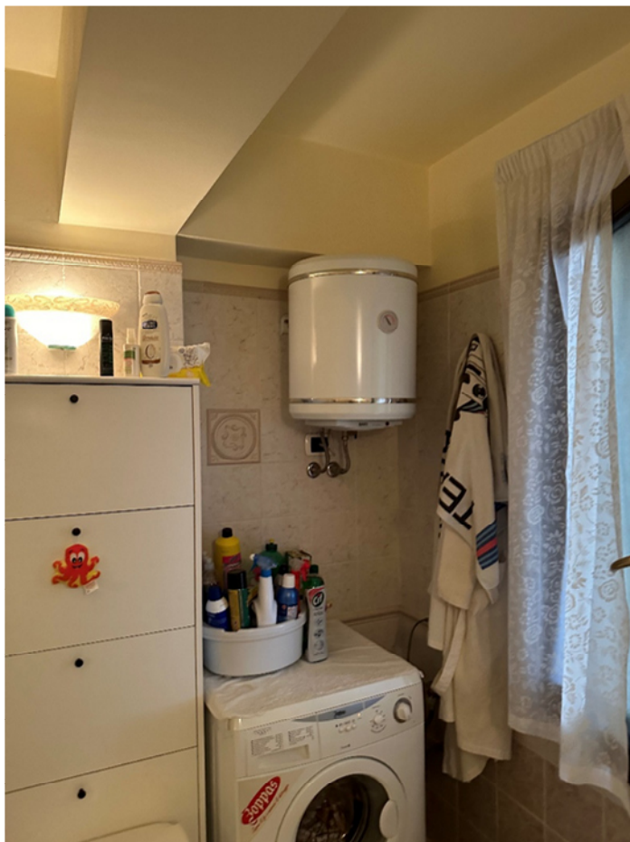
Foto nr.7 : particolare del bagno e dello scaldino elettrico
