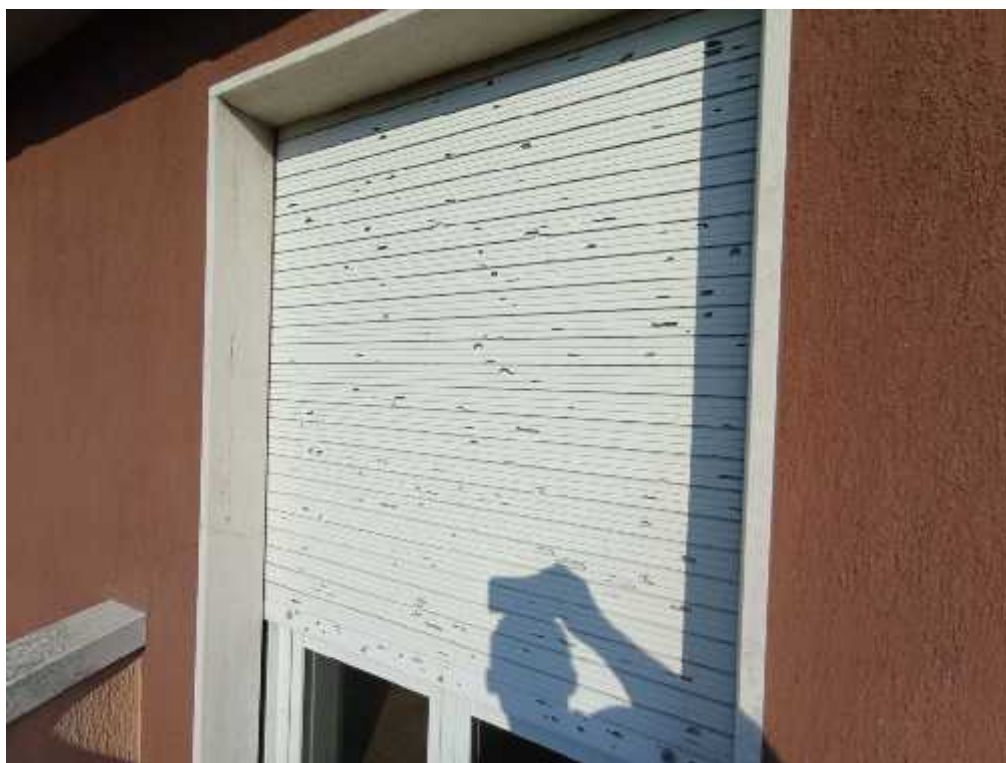
PARTICOLARE STATO TAPPARELLE
