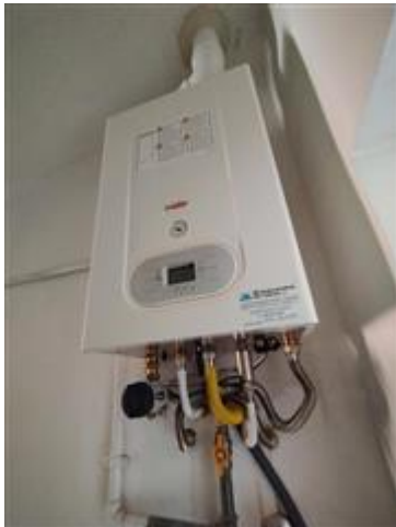
Caldaia termo-sanitaria in comune con il sub 3
