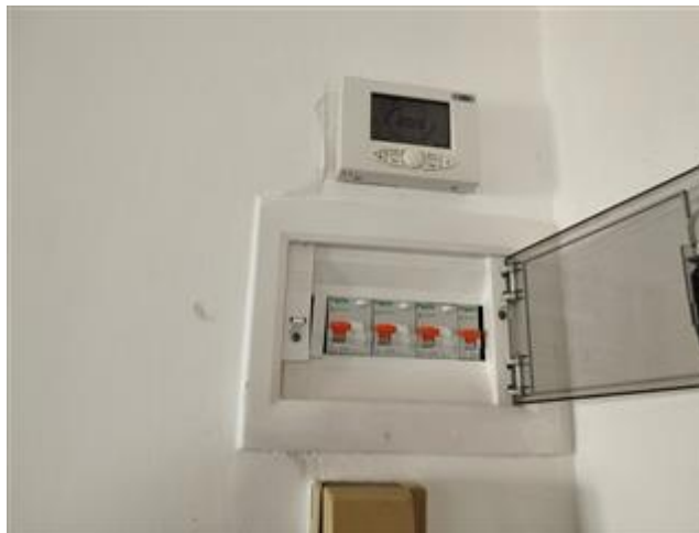
Quadro elettrico appartamento
