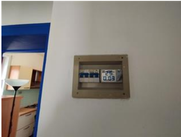
Quadro elettrico appartamento
