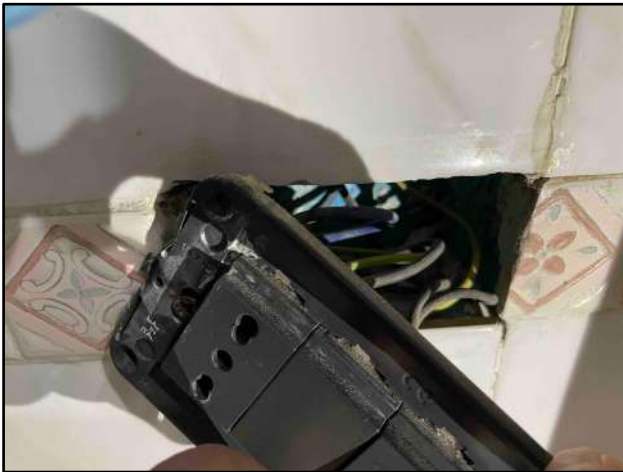
Interno di una cassetta 503
