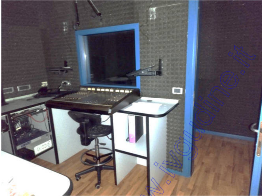
Particolare sala regia (all'interno del vano ripostiglio)
