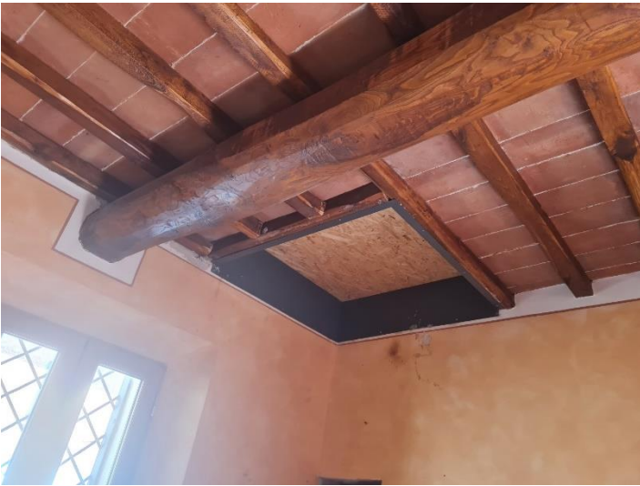
Foro praticato nel solaio tra i due livelli, chiuso da pannello in legno
