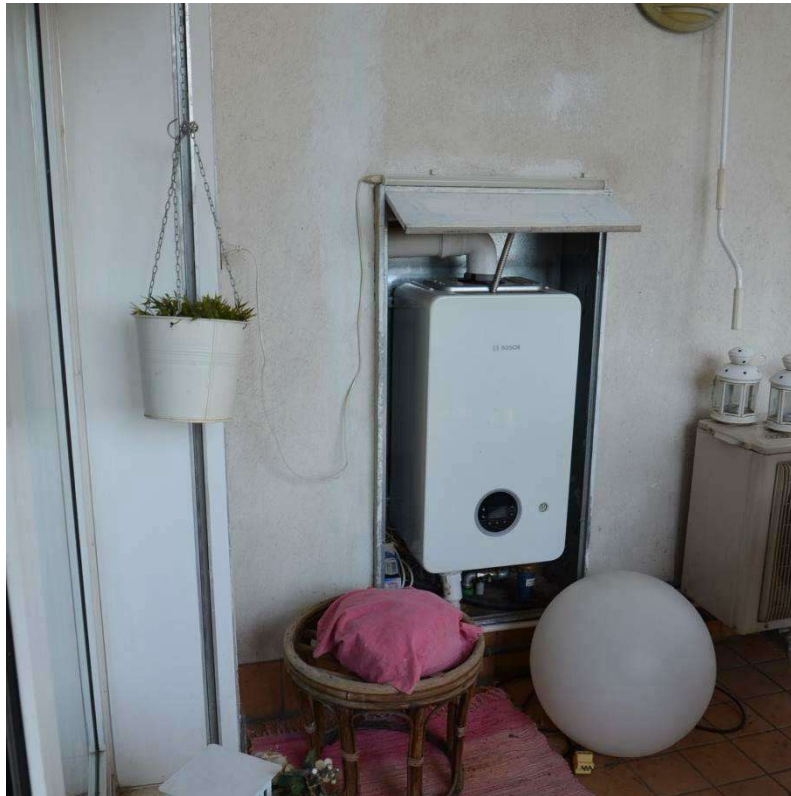
Caldaia in terrazza piano primo
