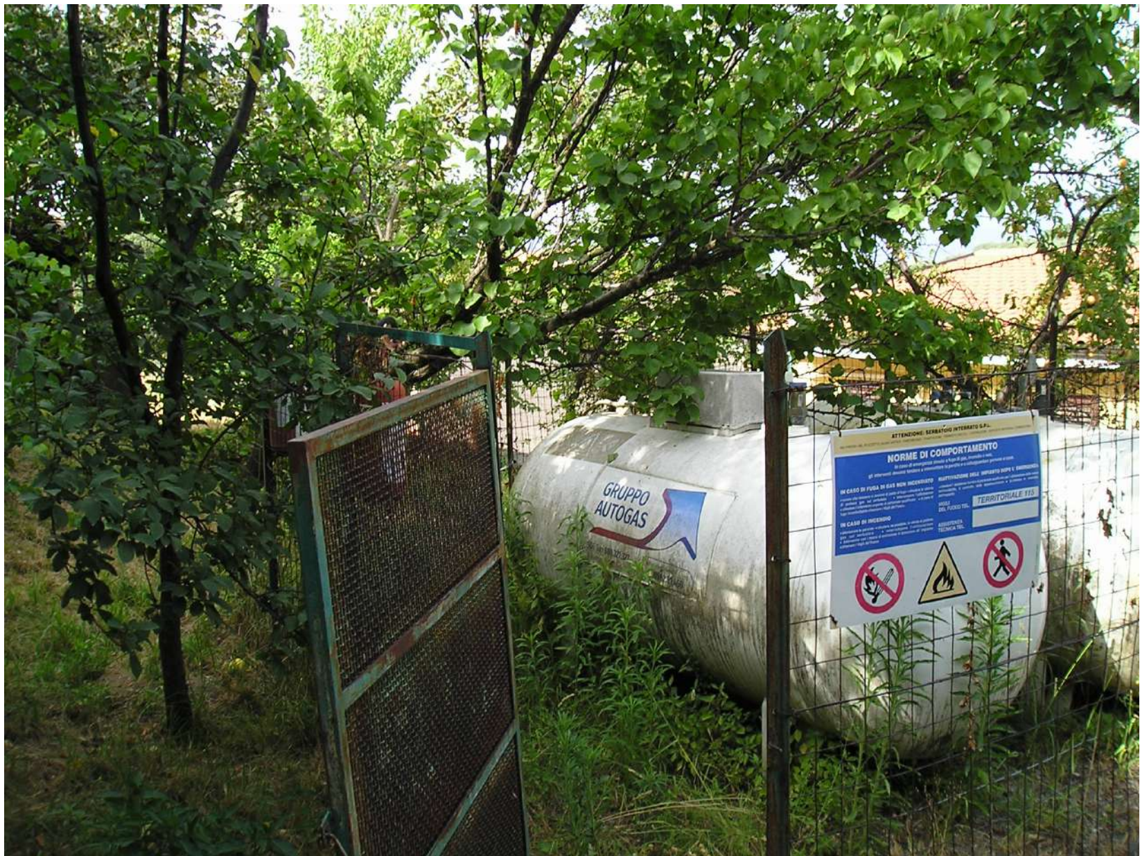
Foto n. 43: Corte – ubicazione bombolone a GPL
