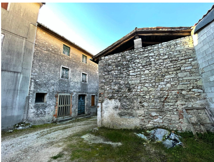
Prospetto Est dell'edificio (corpo di fabbrica di servizio ad uso autorimessa con soffitta)
