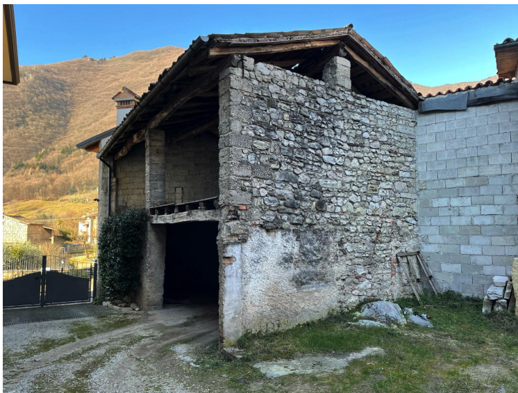
Prospetti Sud ed Est dell'edificio (corpo di fabbrica di servizio ad uso autorimessa con soffitta)
