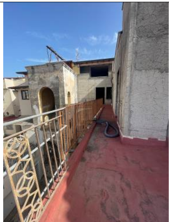
Fotografia n. 8 _ Collegamento tra balcone e terrazzo al secondo piano
