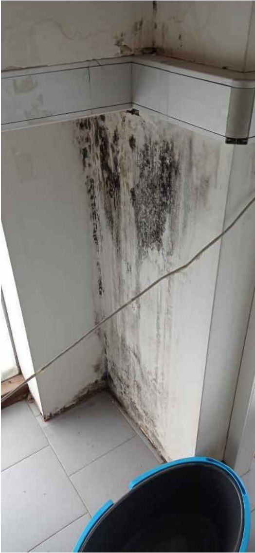
63-problematiche riscontrate a piano primo
