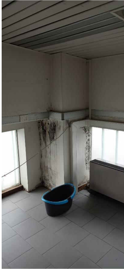
64-problematiche riscontrate a piano primo
