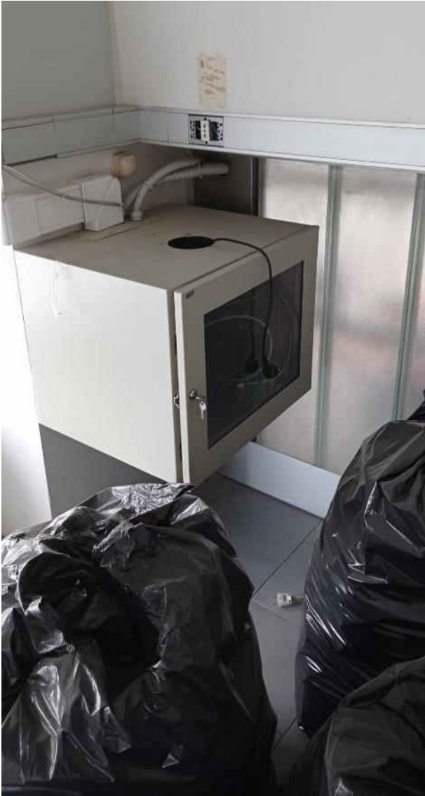
61-dettaglio impianto elettrico piano primo
