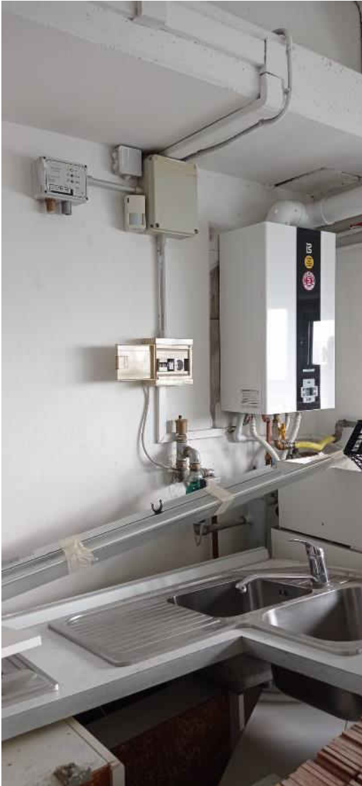
79-impianti bagno piano terreno
