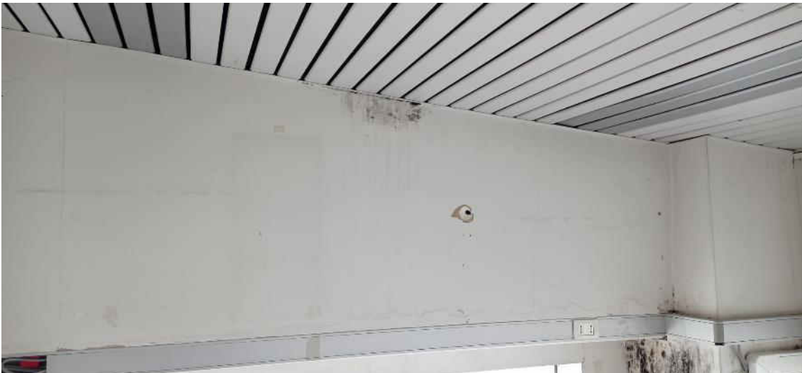
58-dettaglio stato di manutenzione piano primo
