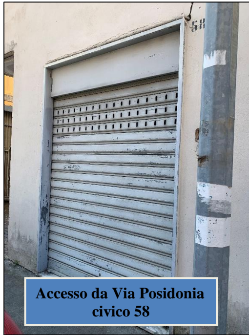
Foto 5: viste della saracinesca di ingresso (al momento non funzionante a causa delle utenze disattivate ) al locale commerciale sito al civico 58 ( DEPOSITO A ).
