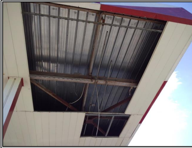
Figura 9 Parziale distacco del rivestimento inferiore
