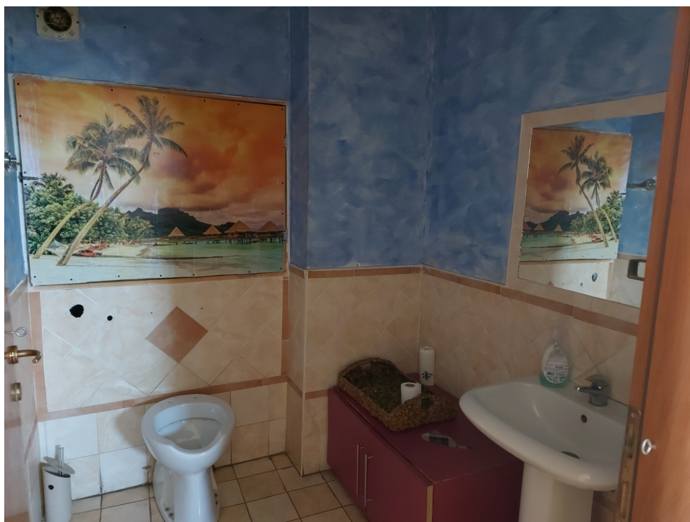
FOTO N. 5-6- Altre viste del locale commerciale di PT sito in comune di Poggio Nativo, via Farense snc, individuato al NCEU del detto comune al foglio n. 5 part. n. 167 sub 20, catg. C/1, mq 128 R.C. € 2.188,12 (bagno e sala giochi)
