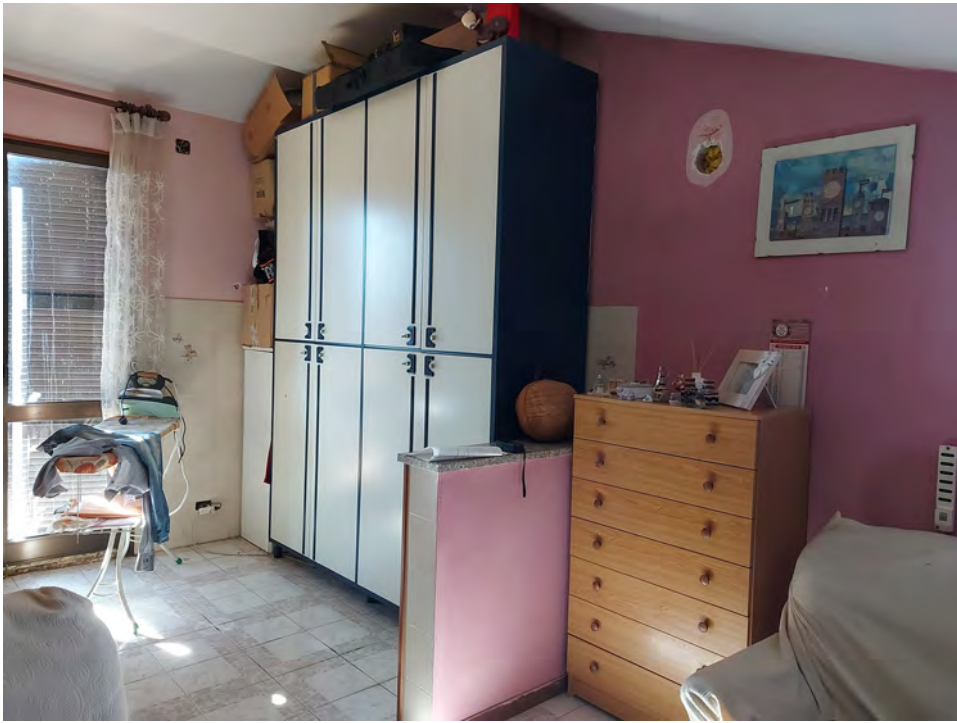
FOTO N. 15- Vista dei locali di sottotetto adibiti ad abitazione in assenza di titolo edilizio Appartamento di civile abitazione sito in Comune di Poggio Nativo, via Farense snc, individuato al NCEU del detto comune al fg. 5 part. n. 167 sub 19, PT-1-2 categoria A/2 vani 11, R.C. € 766,94
