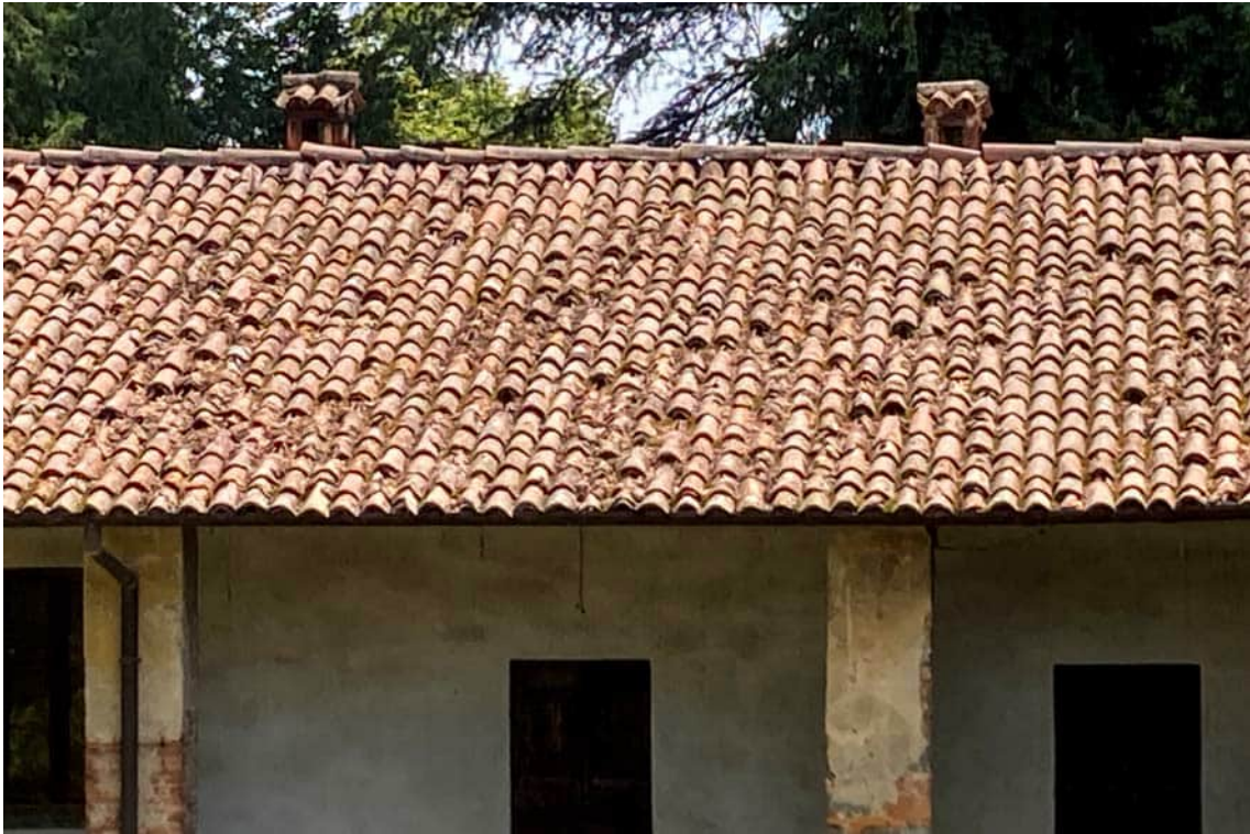
Tegole deteriorate e sporgenti oltre il canale di gronda
