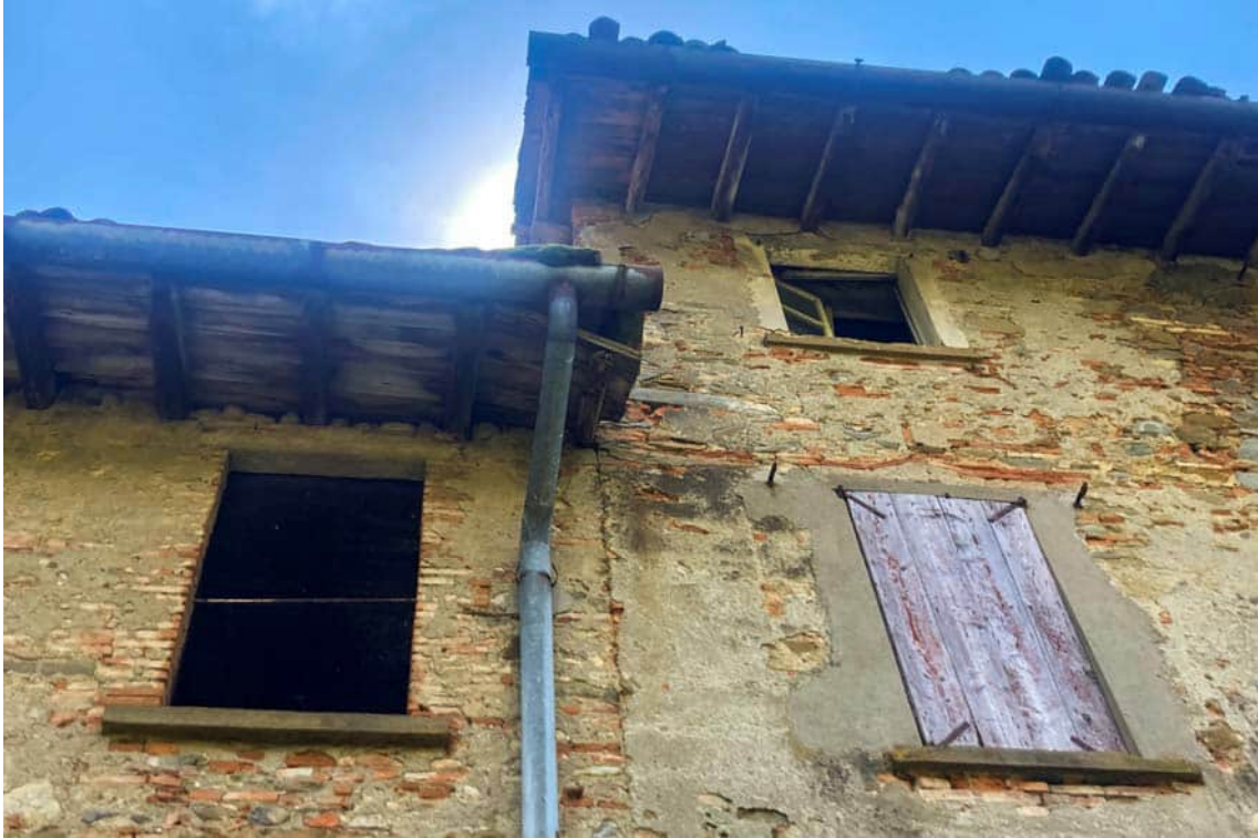
Tegole sporgenti oltre il canale di gronda e canali intasati dal muschio
