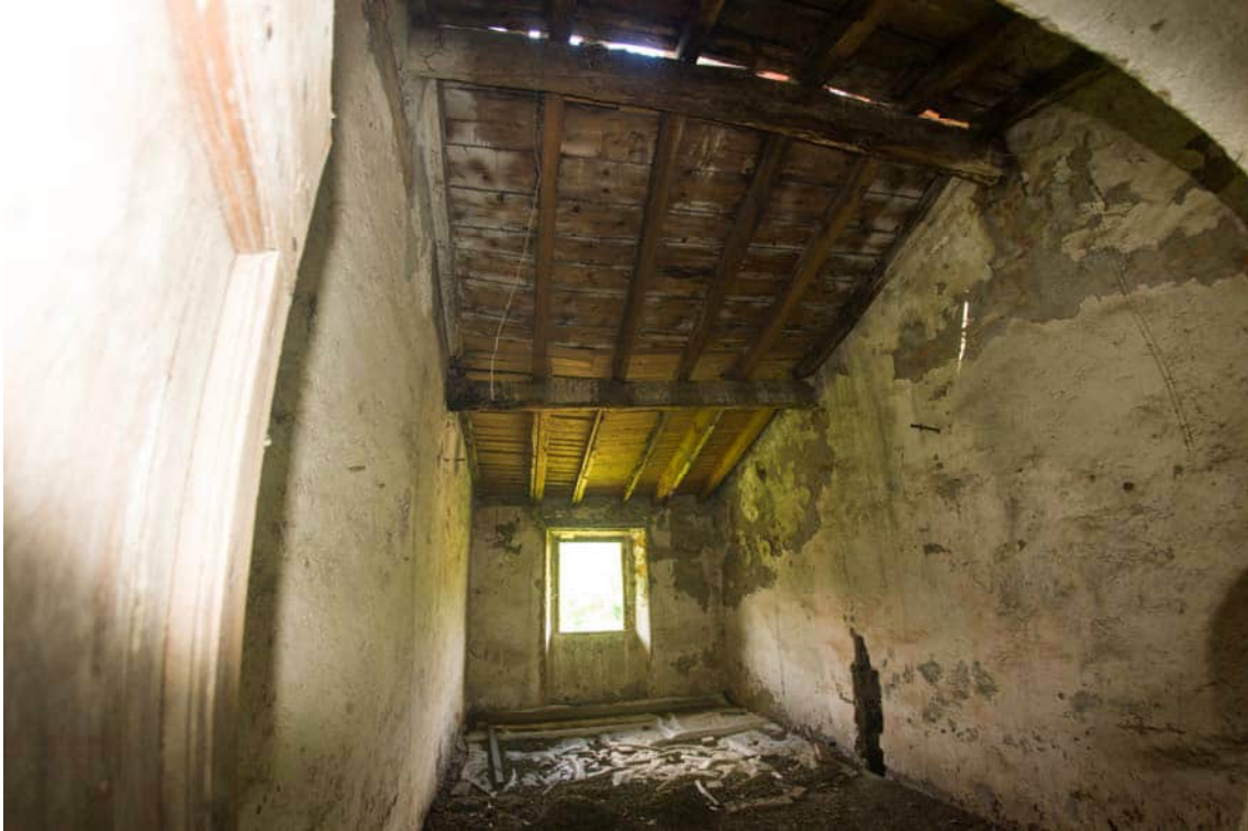
Tetto, solaio e muri ammalorati, aperture prive di finestre e oscuranti
