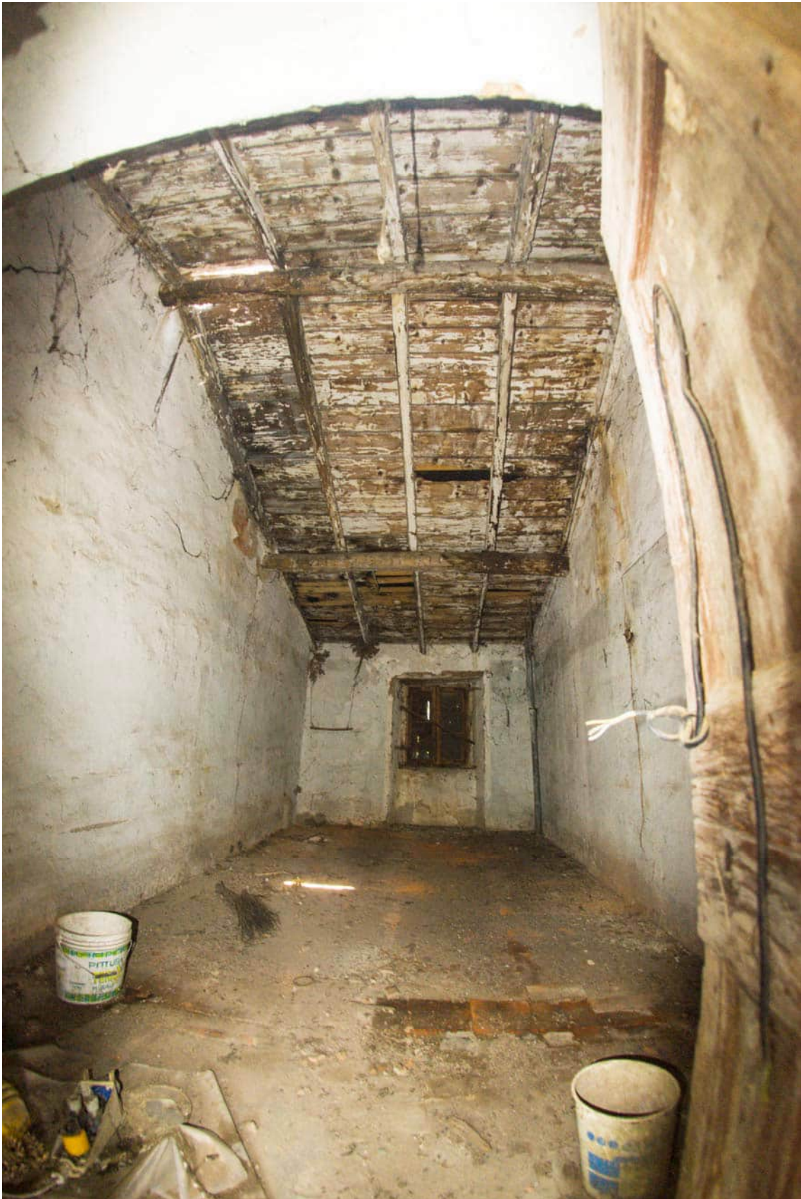
Tetto ammalorato e solaio imbarcato
