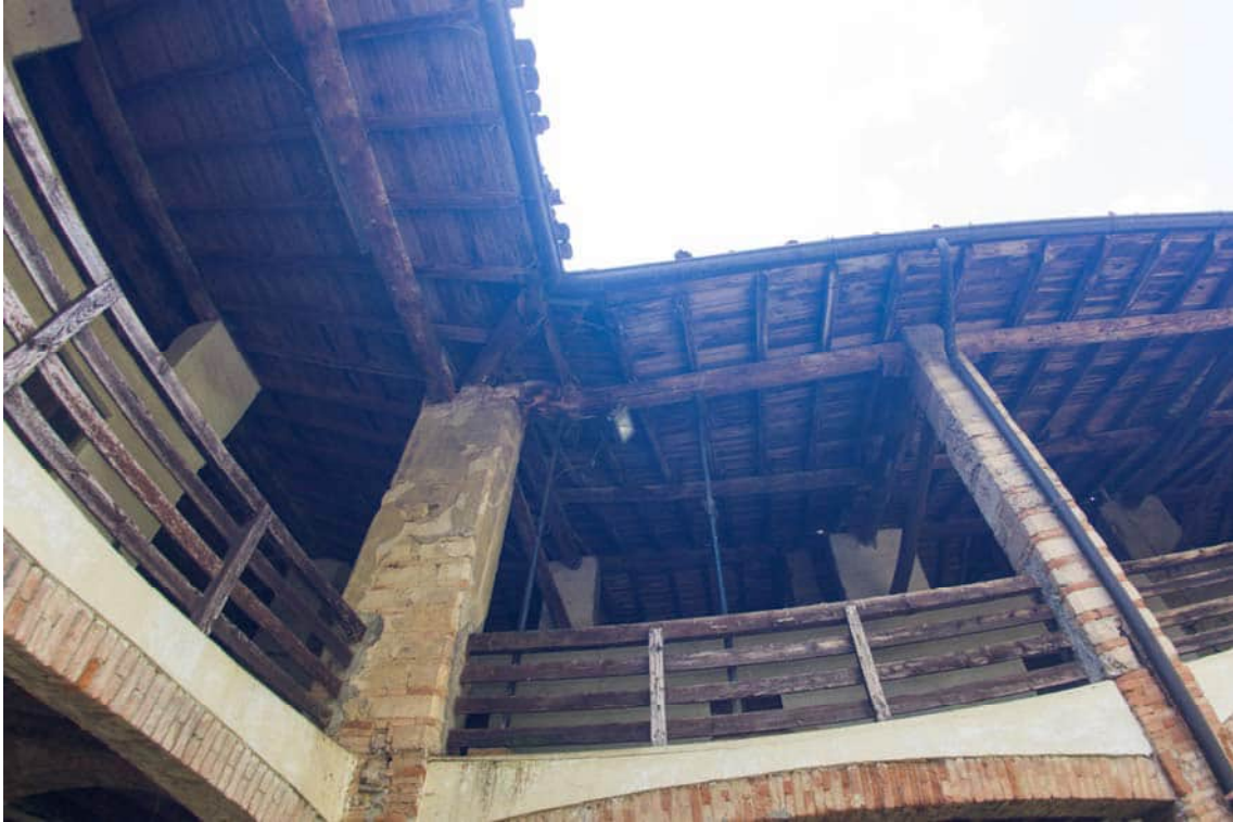
Trave in legno spezzata e puntellata e tegole sporgenti oltre il canale di gronda
