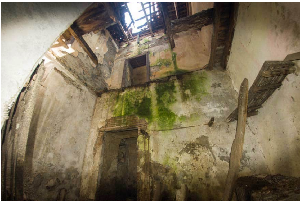
Solaio e tetto crollati muri ammolorati
