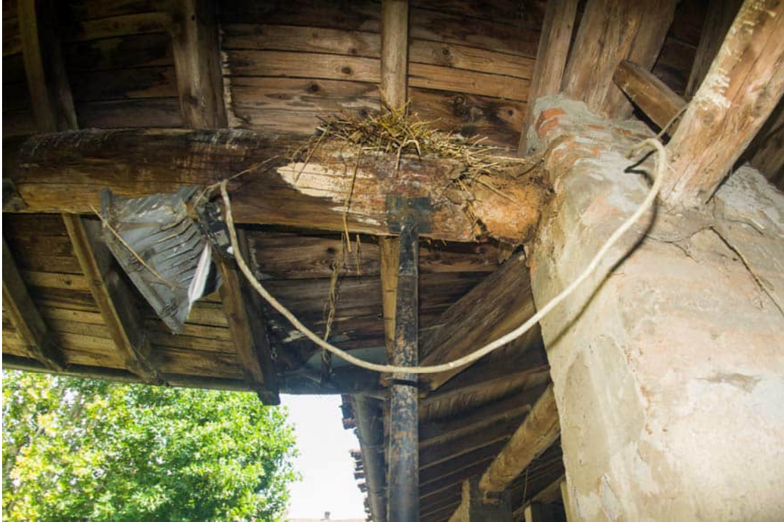
Trave in legno spezzata e tegole sporgenti oltre il canale di gronda
