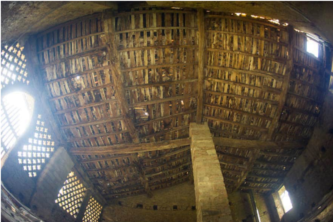
Porzione di tetto con diverse aperture nel manto di copertura
