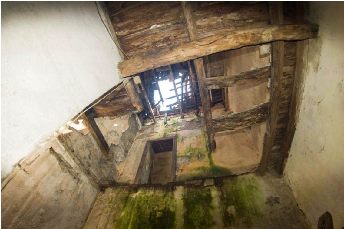
Solaio e tetto crollati muri ammalorati
