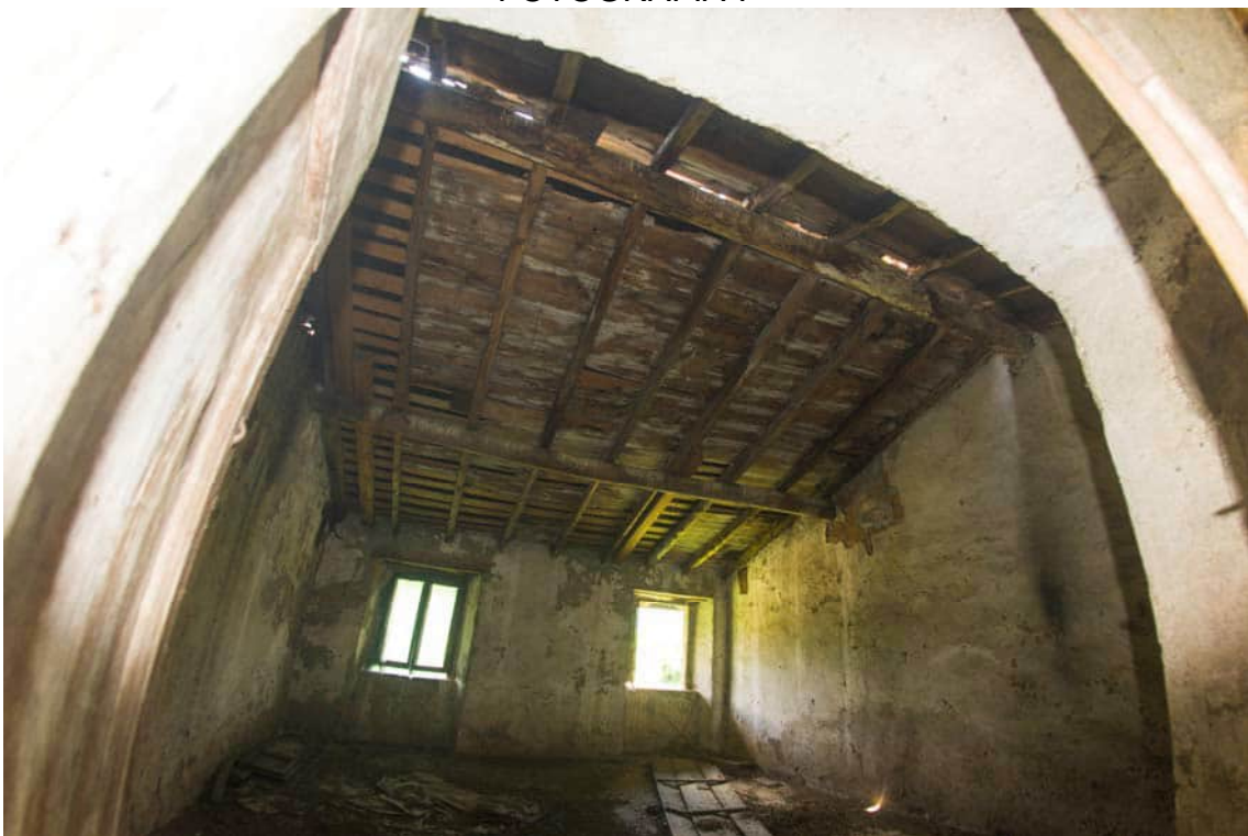
Tetto ammalorato, solaio imbarcato e sfondato
