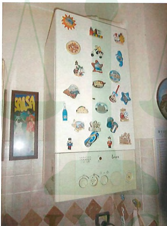
caldaia riscaldamento marca Laser
