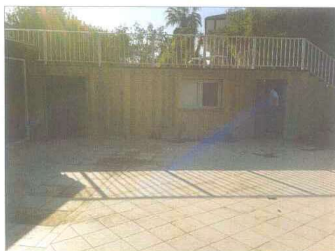
Foto 30 Locali pompe e deposito della piscina
