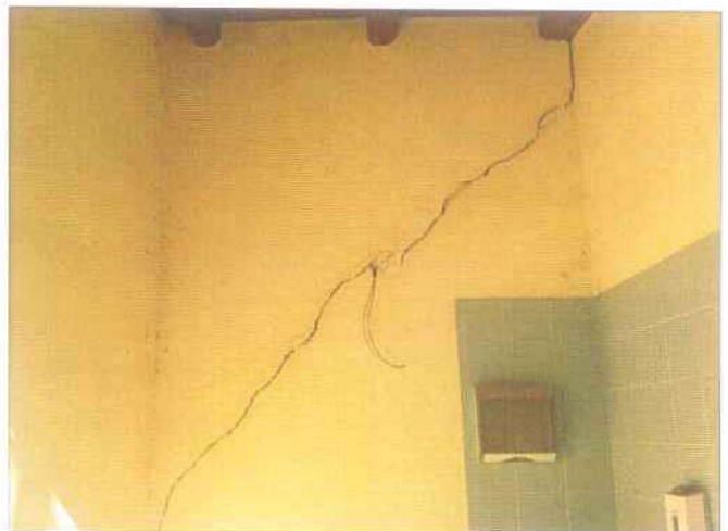
Foto 24 blocco servizi igienici (lesione passante)
