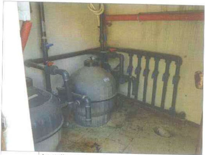
Foto 32 Locali pompe e deposito della piscina
