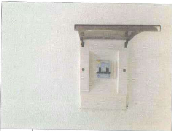
Foto 13 particolare quadretto elettrico camere piano terra
