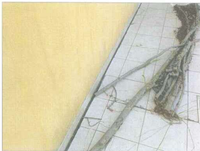
Foto 26 blocco servizi igienici (cedimento marciapiedi esterno)
