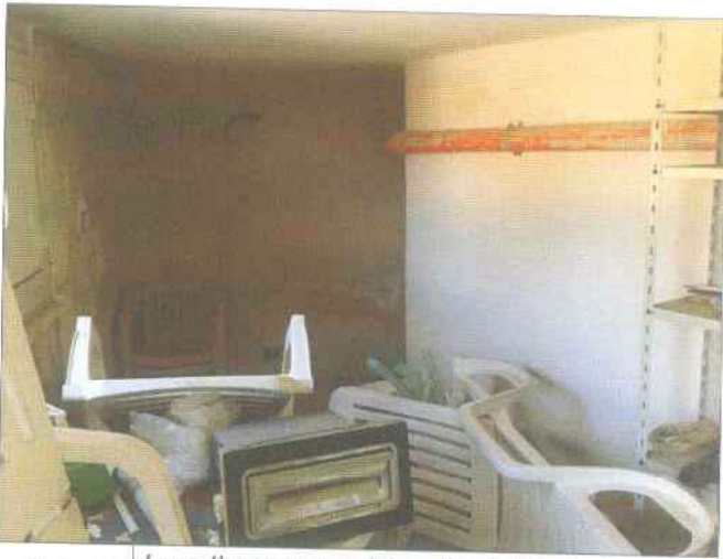
Foto 31 Locali pompe e deposito della piscina
