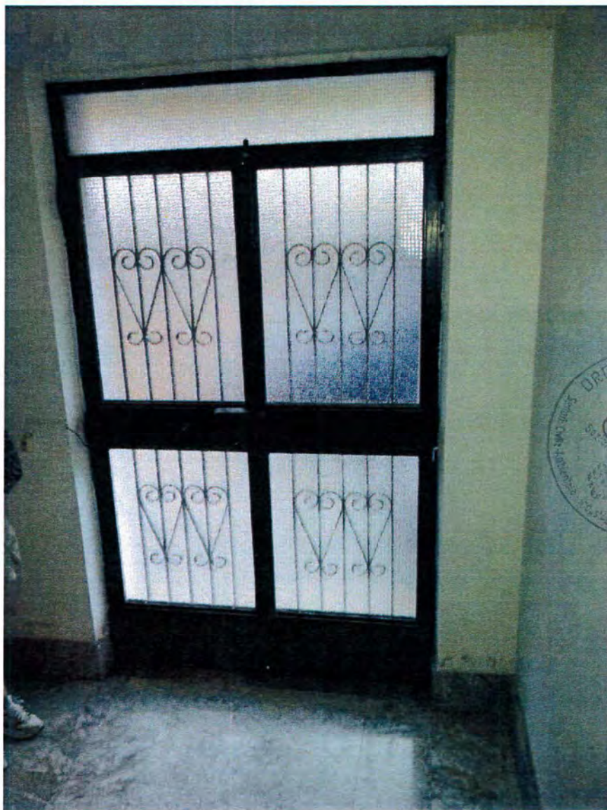
Foto n°1 :- Portoncino di accesso al vano scala condominiale del fabbricato in Torano Castello (Sartano) (CS) al fg. n°13, p.lla n°820;
