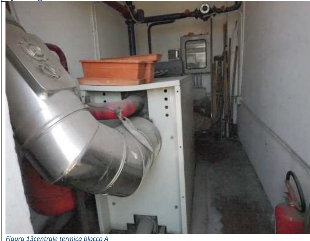
Figura 13 centrale termica blocco A
