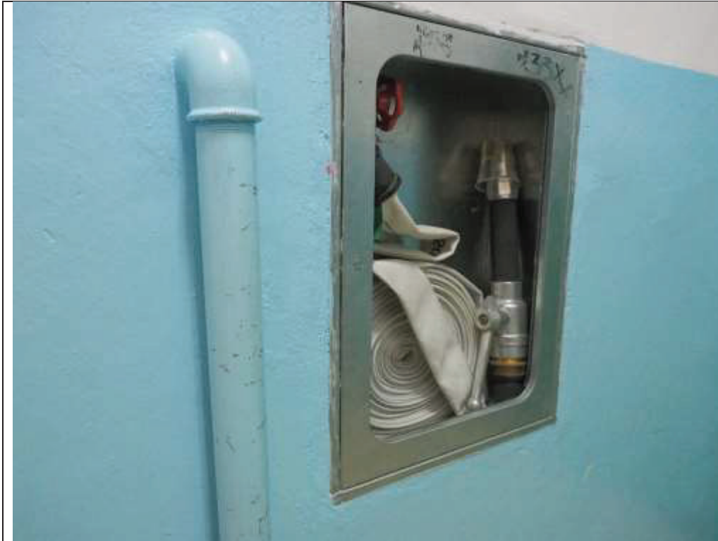
Figura 20 particolare impianto antincendio
