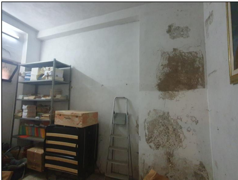
Foto 23– Tracce di infiltrazioni sul pilastro
