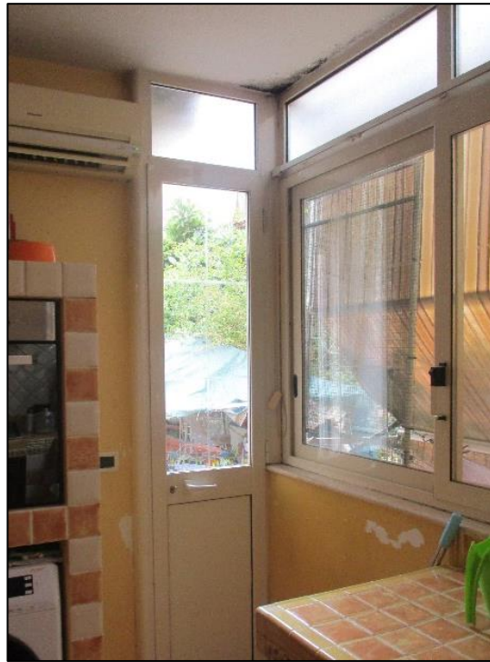
Foto 19 – tracce di umidità da condensa
