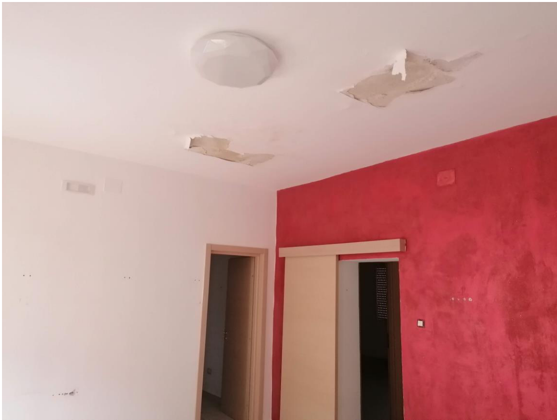
Foto n° 9 – Unità immobiliare al 2° piano del fabbricato sito in Gela nella via Monti 3. In Catasto al foglio 177 part.IIa 115 sub 6; Soggiorno, screpolature della tinteggiatura dovute ad infiltrazioni d'acqua provenienti dal lastrico solare.
