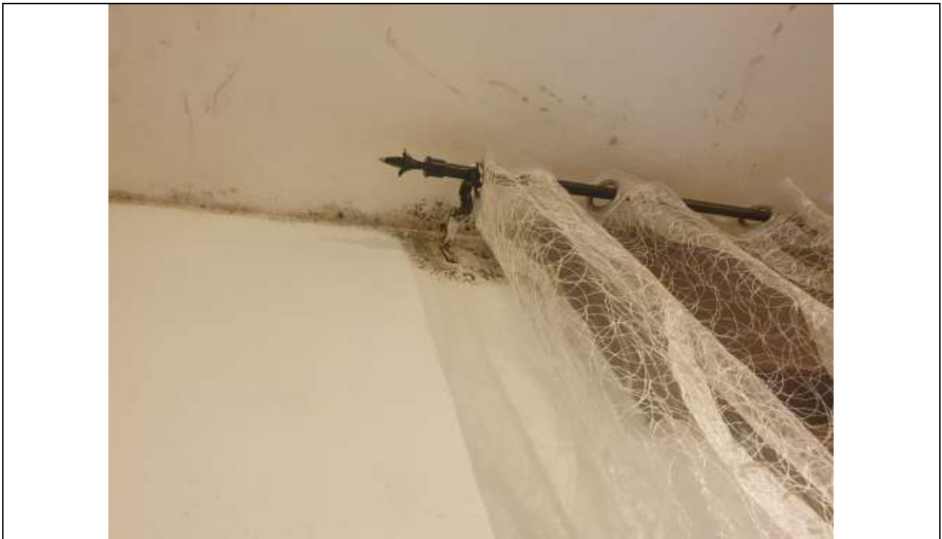
36 Particolare sul soffitto e parete interna alla camera da letto singola, dove si nota la presenza di muffe;
