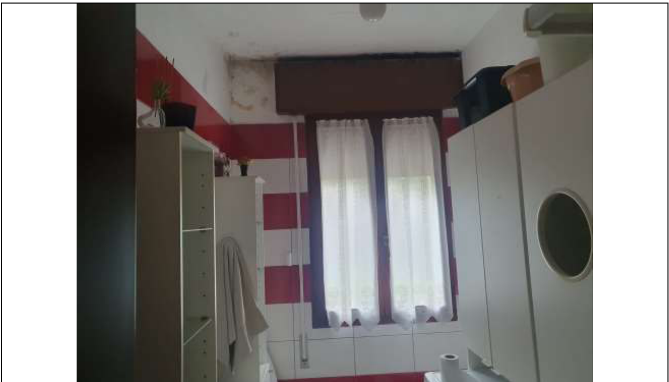
28 Vista interna del bagno, verso la parete della finestra dove si nota la presenza di muffe;
