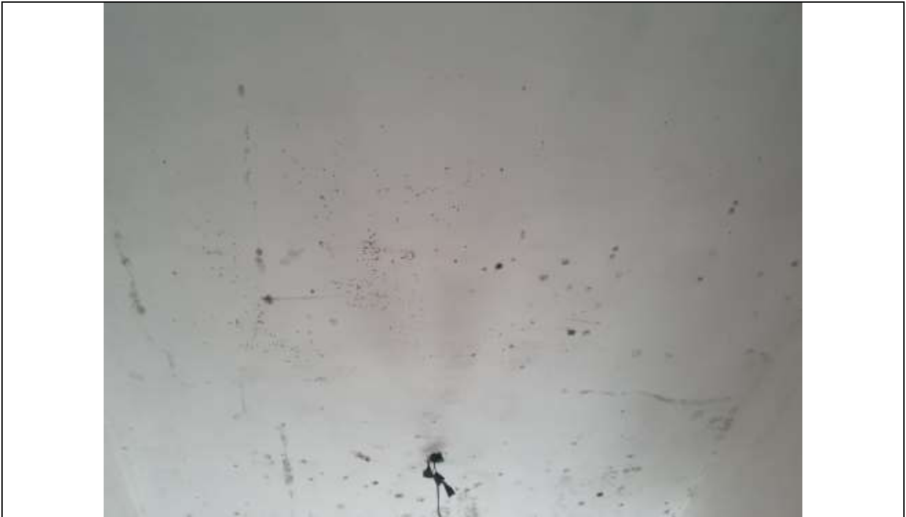
29 Particolare del soffitto del bagno, con presenza di muffe;
