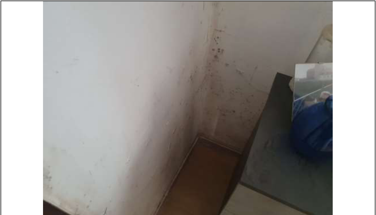
33 Particolare della parete interna della camera da letto matrimoniale dove si nota la presenza di muffe;
