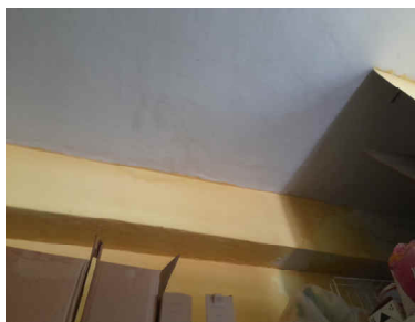
Foto 6 Infiltrazioni in corrispondenza dell'area wc – foto 2
