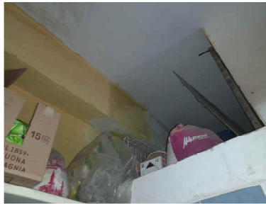
Foto 5 Infiltrazioni in corrispondenza dell'area wc
