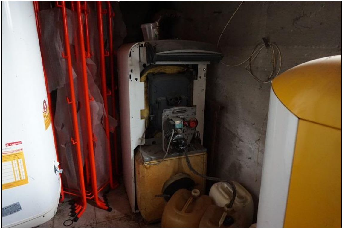
FOTO 33 – Piano seminterrato: c.t. con caldaia (dismessa)
