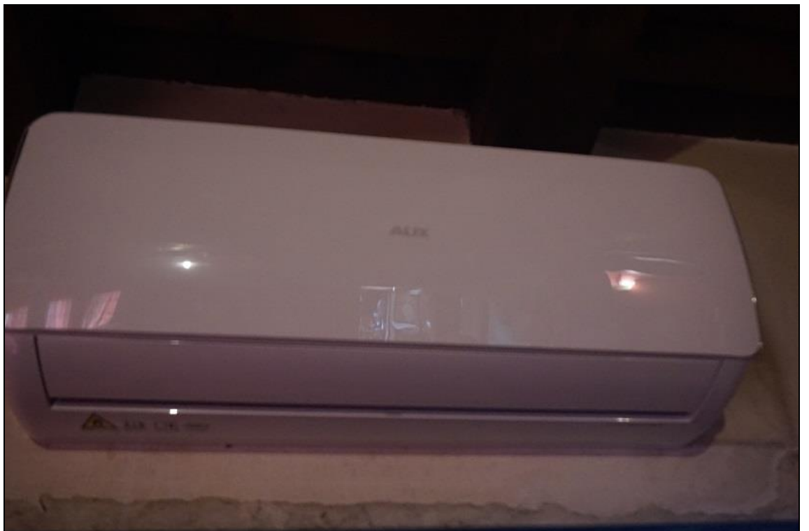
FOTO 46 – Piano primo: climatizzatore in soggiorno
