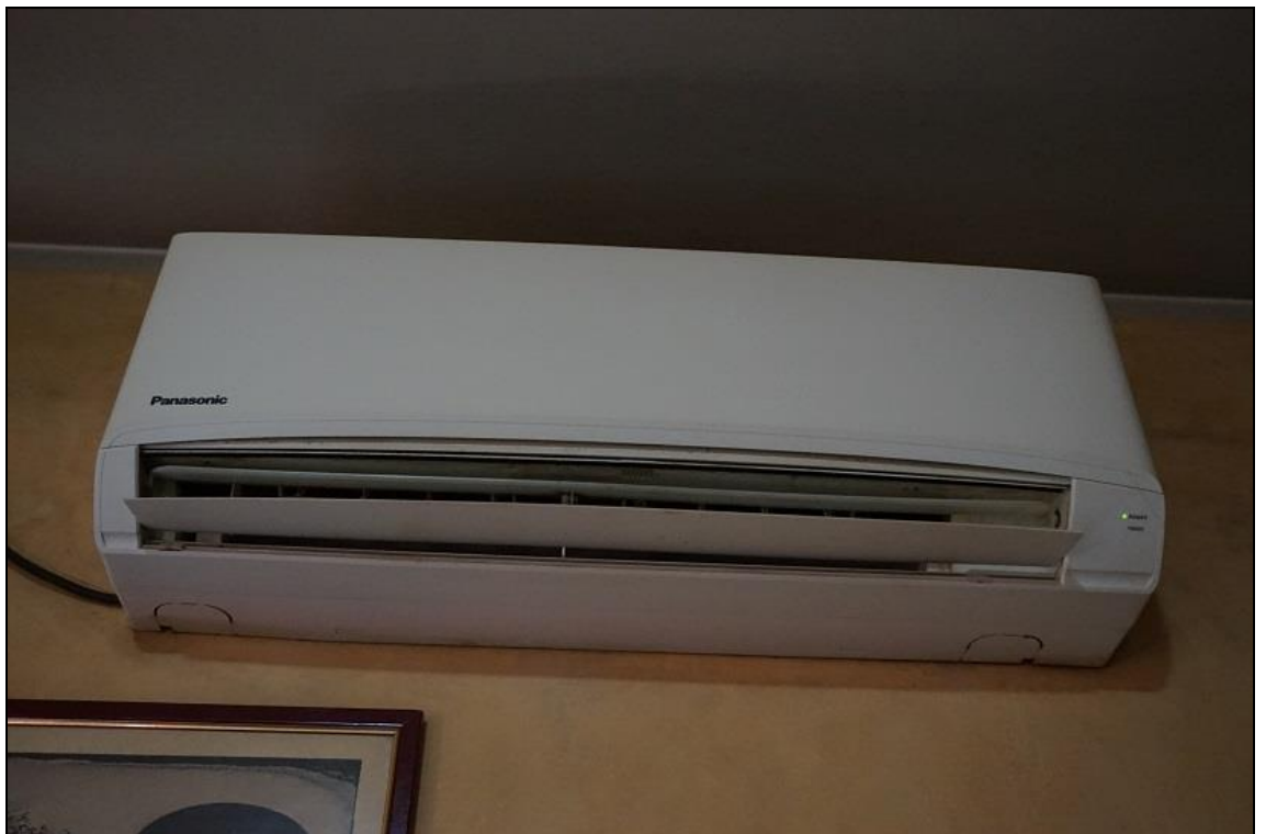
FOTO 16 – Piano rialzato: climatizzatore in soggiorno
