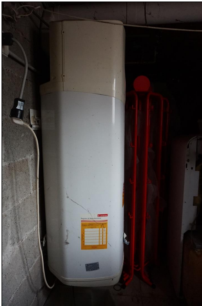
FOTO 32 – Piano seminterrato: boiler elettrico
