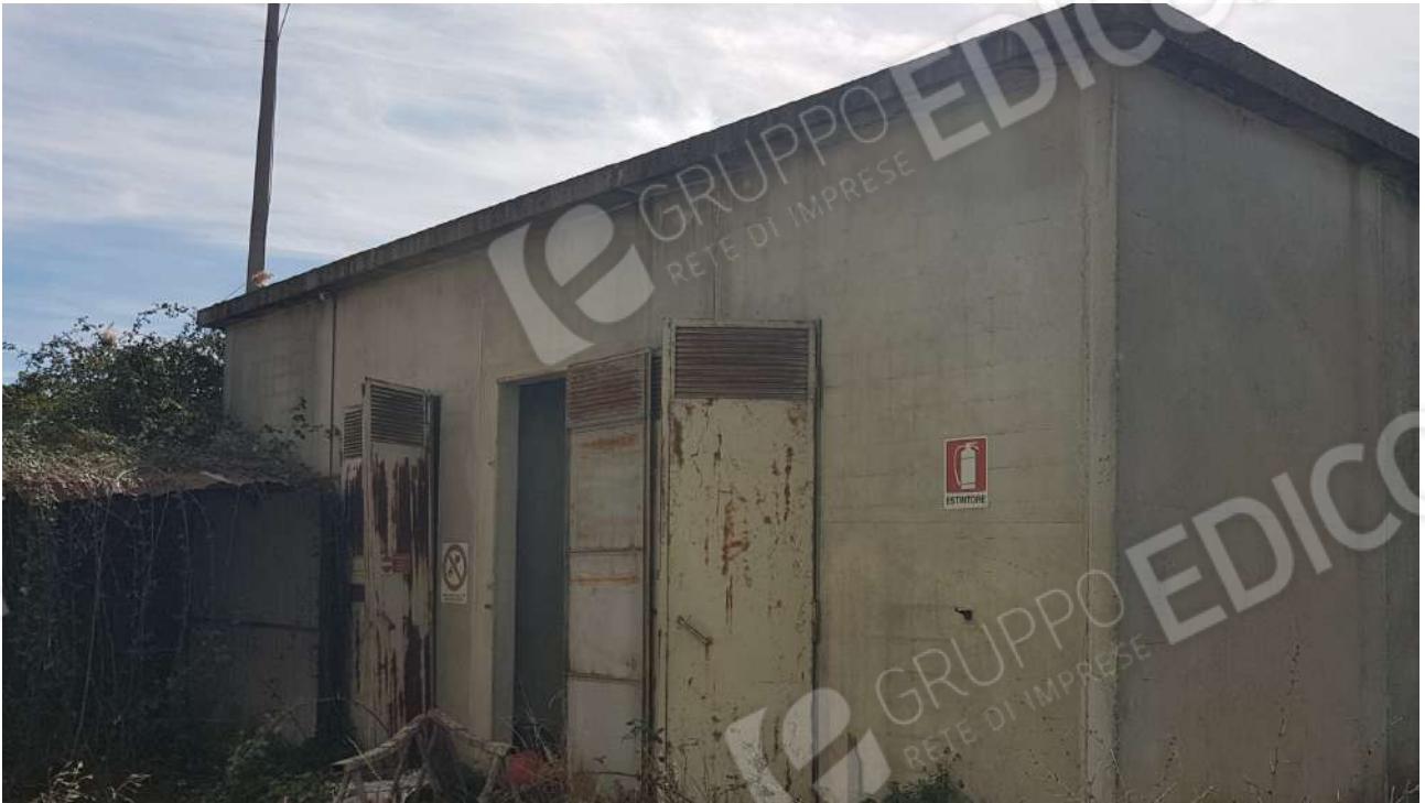
FOTO 5 vista della cabina elettrica (fg. 15-p.Ila 204-sub.3)
